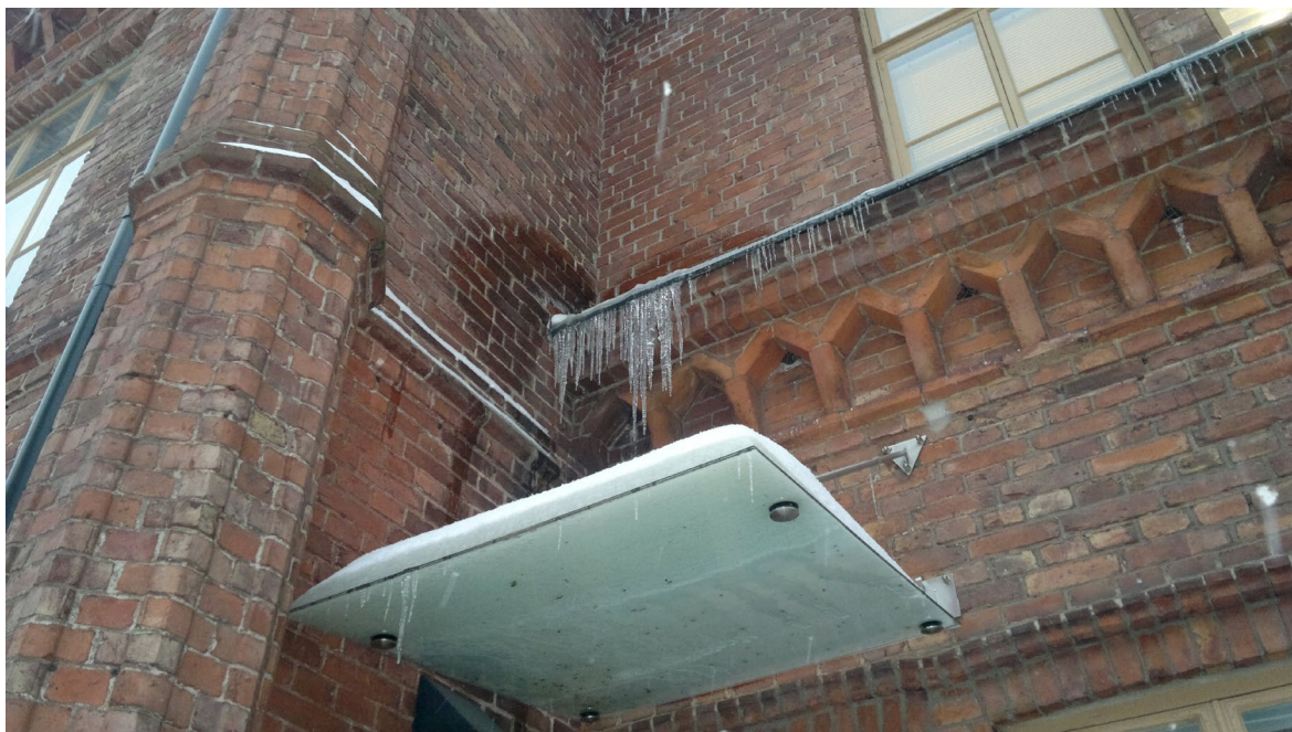
Figur 21: Brister i luftkontrollskiktet och värmekontrollskiktet. Bild tagen av Mikael Andersén
