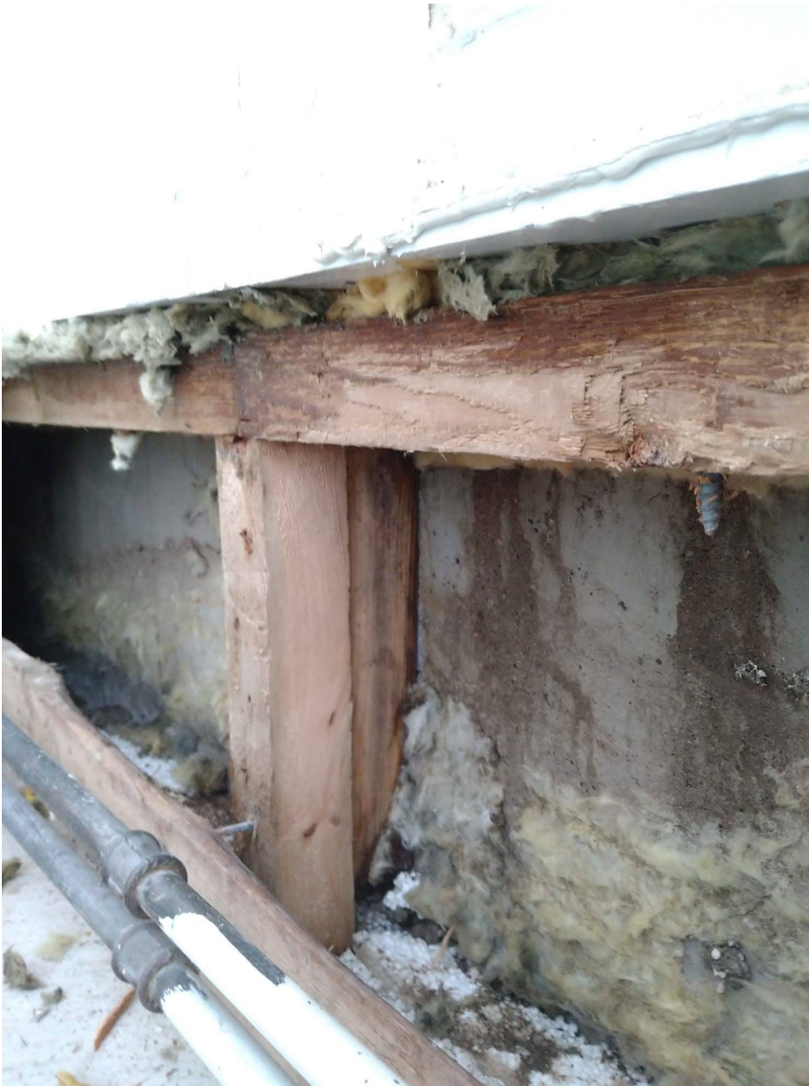
Figur 23: Brister i konstruktiva fuktskyddet i grunden med fukt och mögelskador som följd. Bild tagen av Mikael Anderssén
