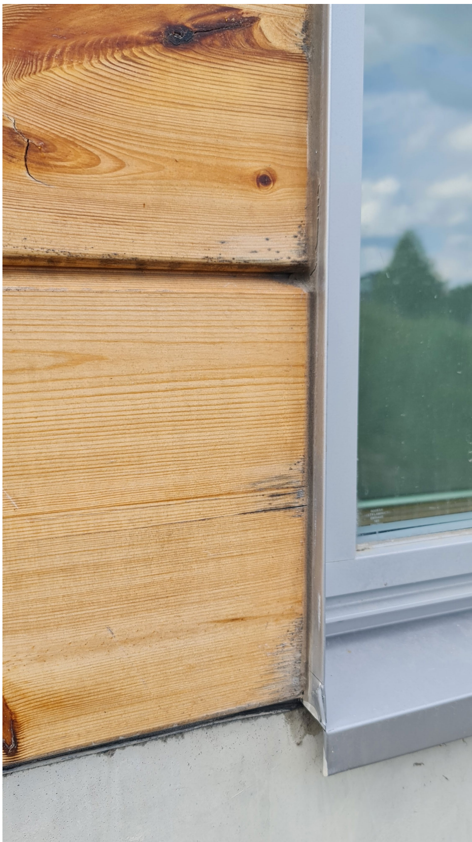
Figur 22: Fasadskada i en ett år gammal byggnad på grund av att fönsterfoder saknas. Bild tagen av Mikael Andersén
