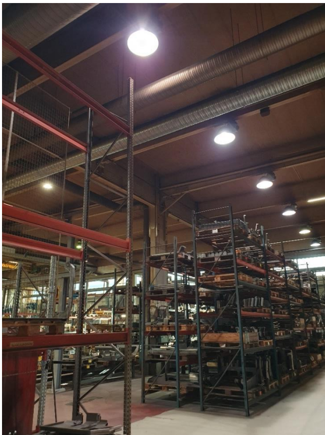
Kuva 2. Vanhojen kattovalaisimien runkoihin asennetut LED-valaisimet
