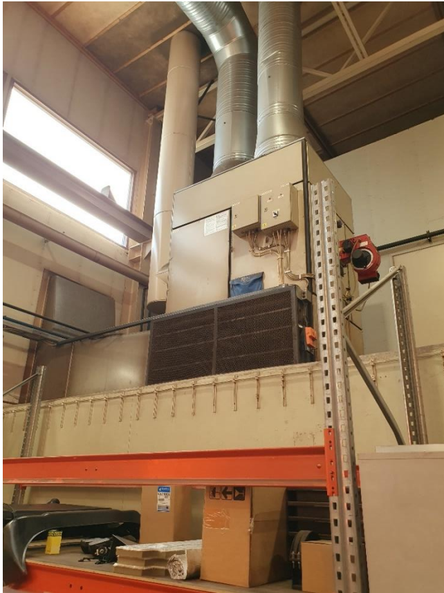
Kuva 3. Kohteessa käytössä oleva Polartherm E-17- ilmalämmitin
