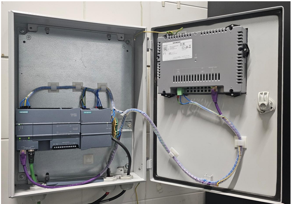
Kuva 29. Ohjauskotelon sisäinen rakenne.
