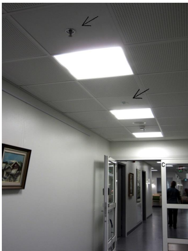
KUVA 11. Kaksi sprinkleriä katossa (Sipilä 2014.)
