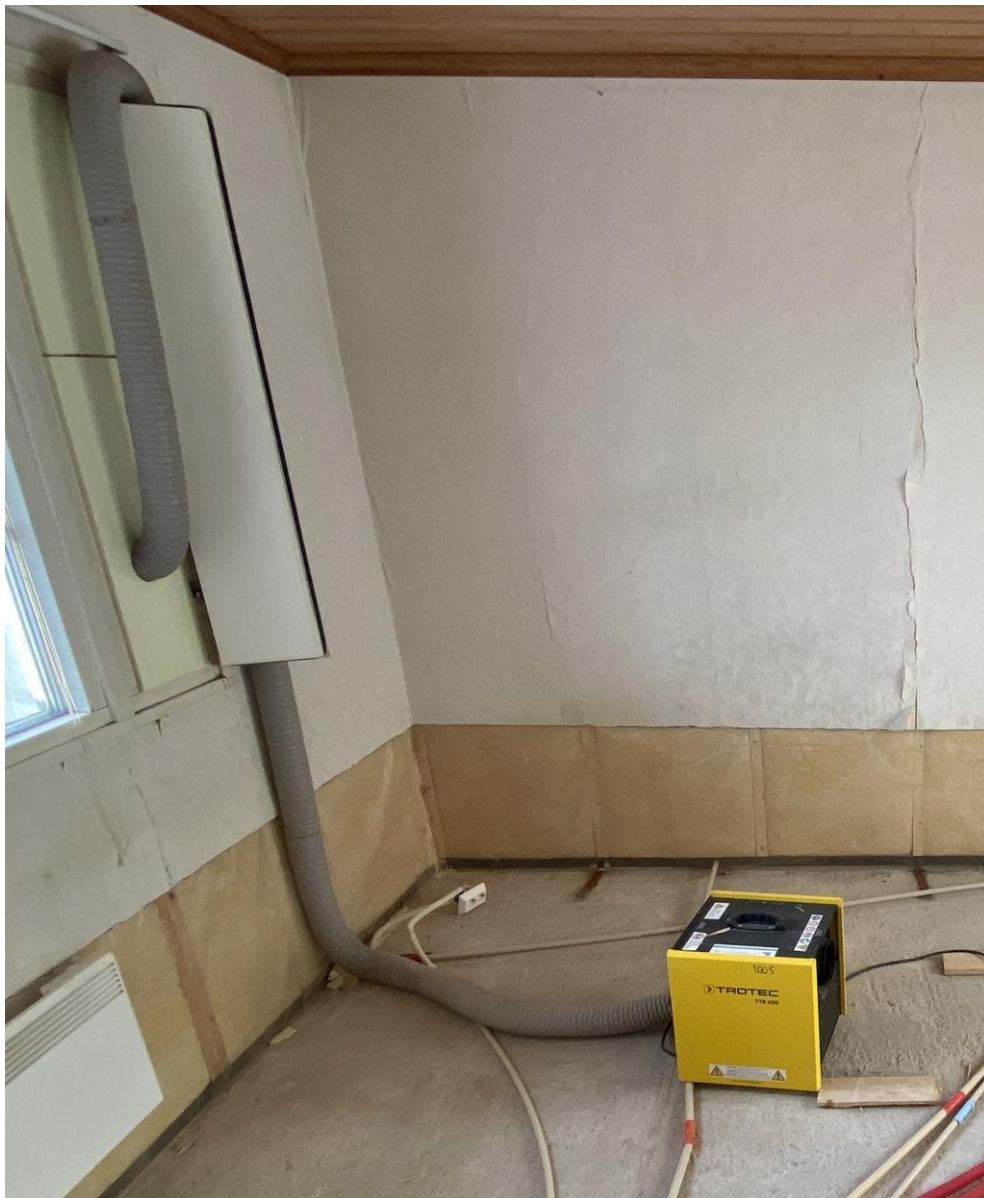
Kuva 14. Adsorptiokuivain, kostea ilma on johdettu ulkoilmaan letkulla.
