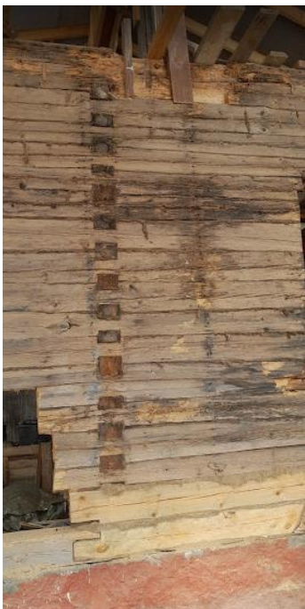
Kuva 34. Vaurioituneen ulkoverhouksen aiheuttama lahovaurio
