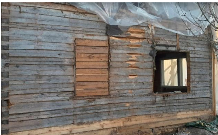
Kuva 27. Sienen aiheuttama lahovaurio
