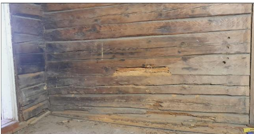
Kuva 35. Lahovaurio keskellä seinää
