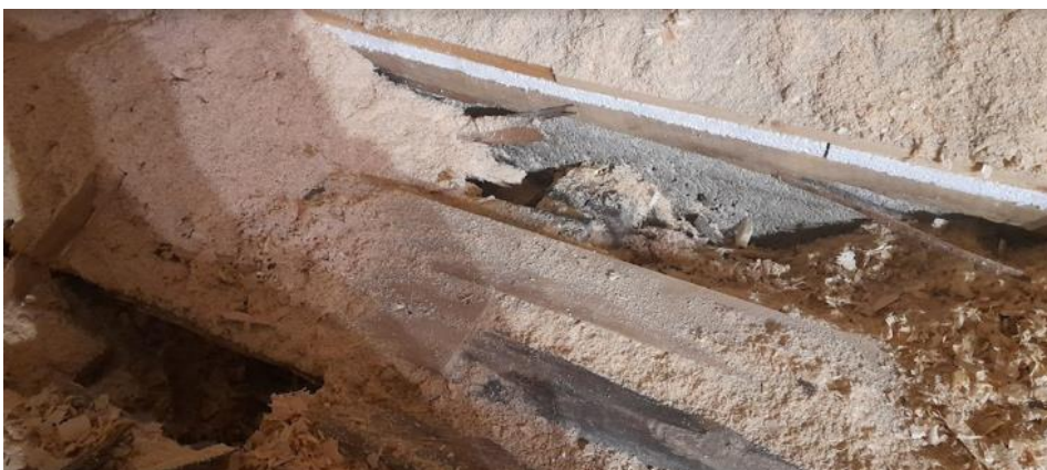
Kuva 38. Lahonnut rossipohjan puurakenne
