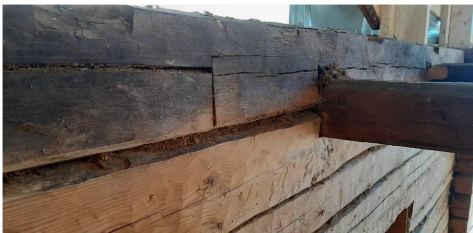
Kuva 39. Yläpohjan eristeen tasolla oleva seinän ylin hirsikerta lahonnut
