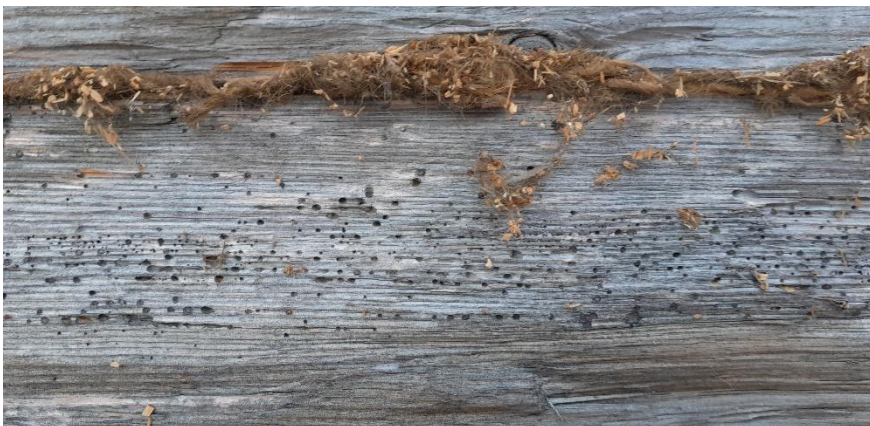
Kuva 30. Hyönteisvaurioita, kuoriaisten ulostuloaukot
