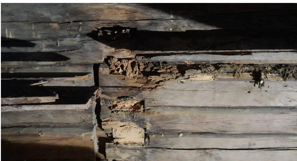
Kuva 33. Kattovuodon aiheuttama lahovaurio
