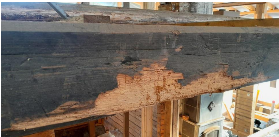
Kuva 40. Yläpohjan eristeen seassa ollut sekundaarikannattaja
