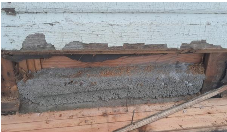
Kuva 35. Virheellisesti tiivistetty luonnonkiviperustus
