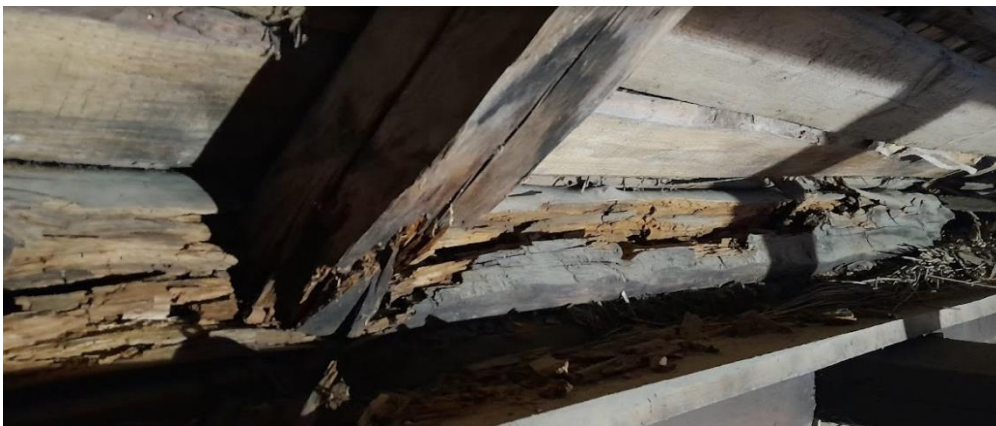
Kuva 32. Kattovuodon aiheuttama lahovaurio
