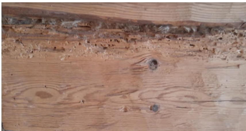
Kuva 31. Hyönteisten vaurioittama hirsi
