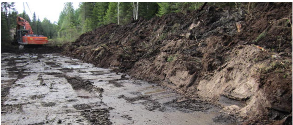
KUVA 25. Tie on toteutettu turvealueelle. Kustannus on yli kaksinkertainen kuvan 24 tilanteeseen verrattuna (Kuva: Ilvesluoto, 2015c).
