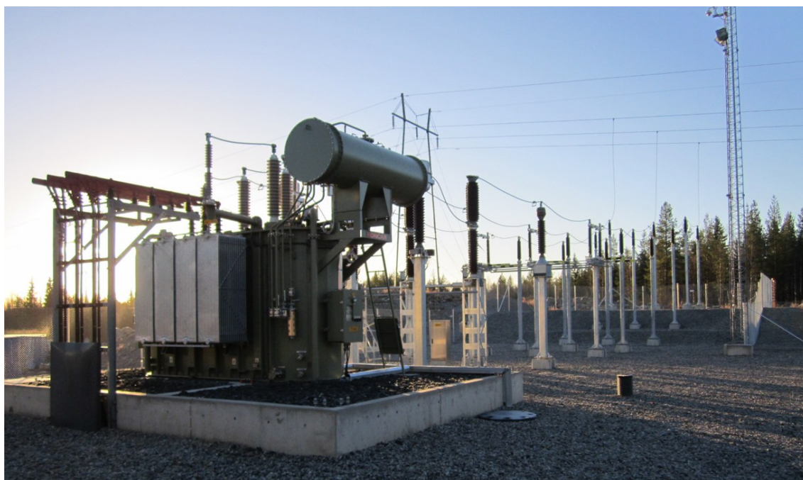
KUVA 10. Sähköaseman kytkinkenttä (Kuva: Ilvesluoto, 2013a).
