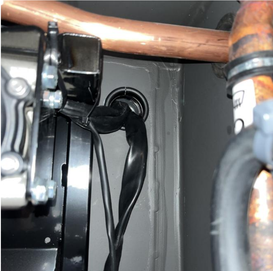
KUVA 7. Lämmitystilan seinä johtojen läpiviennin kanssa (Kuva: Ville Pääkkönen).
