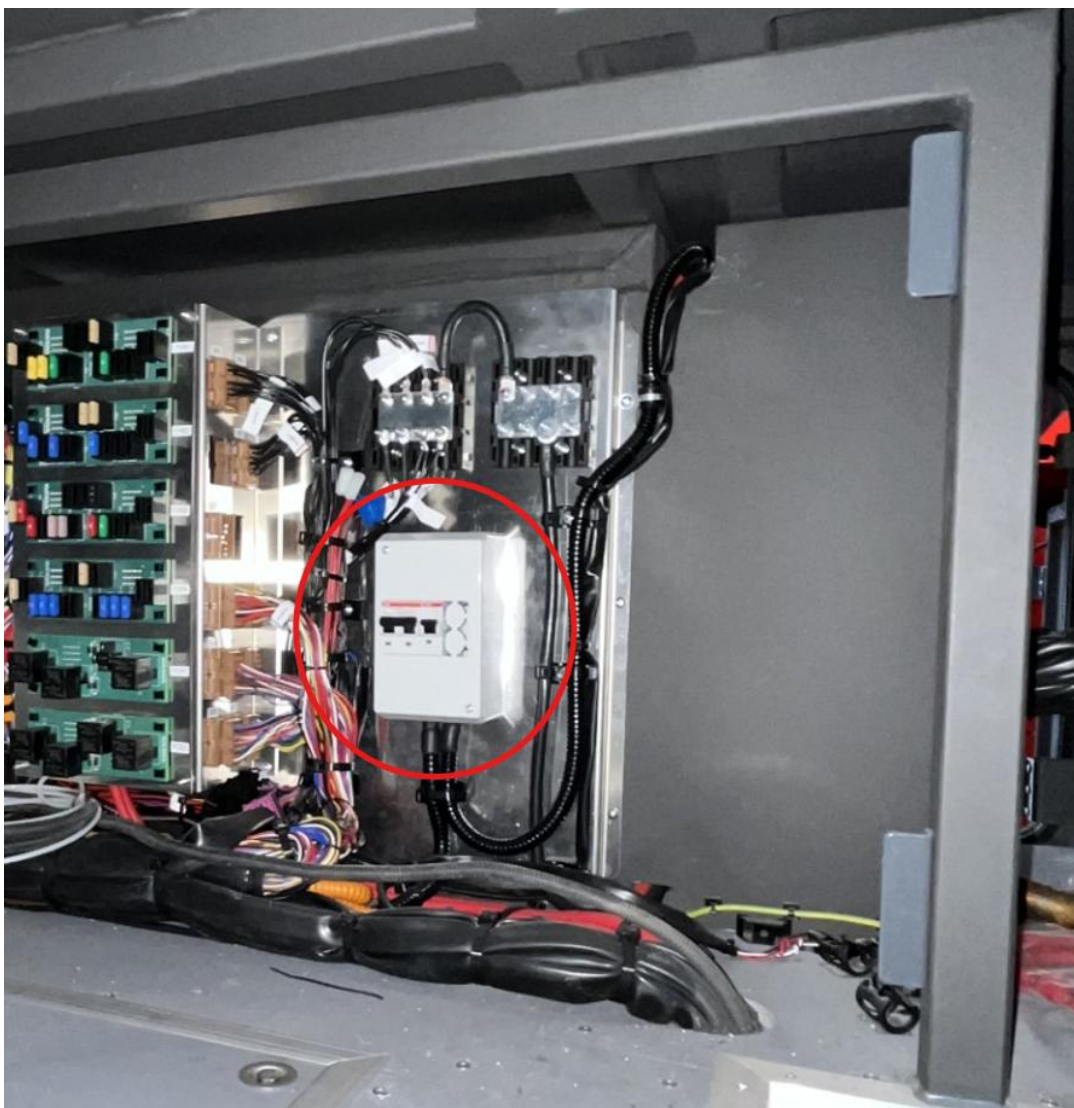
KUVA 11. Sähkökeskus invertterin sulakerasian kanssa (Kuva: Ville Pääkkönen).
