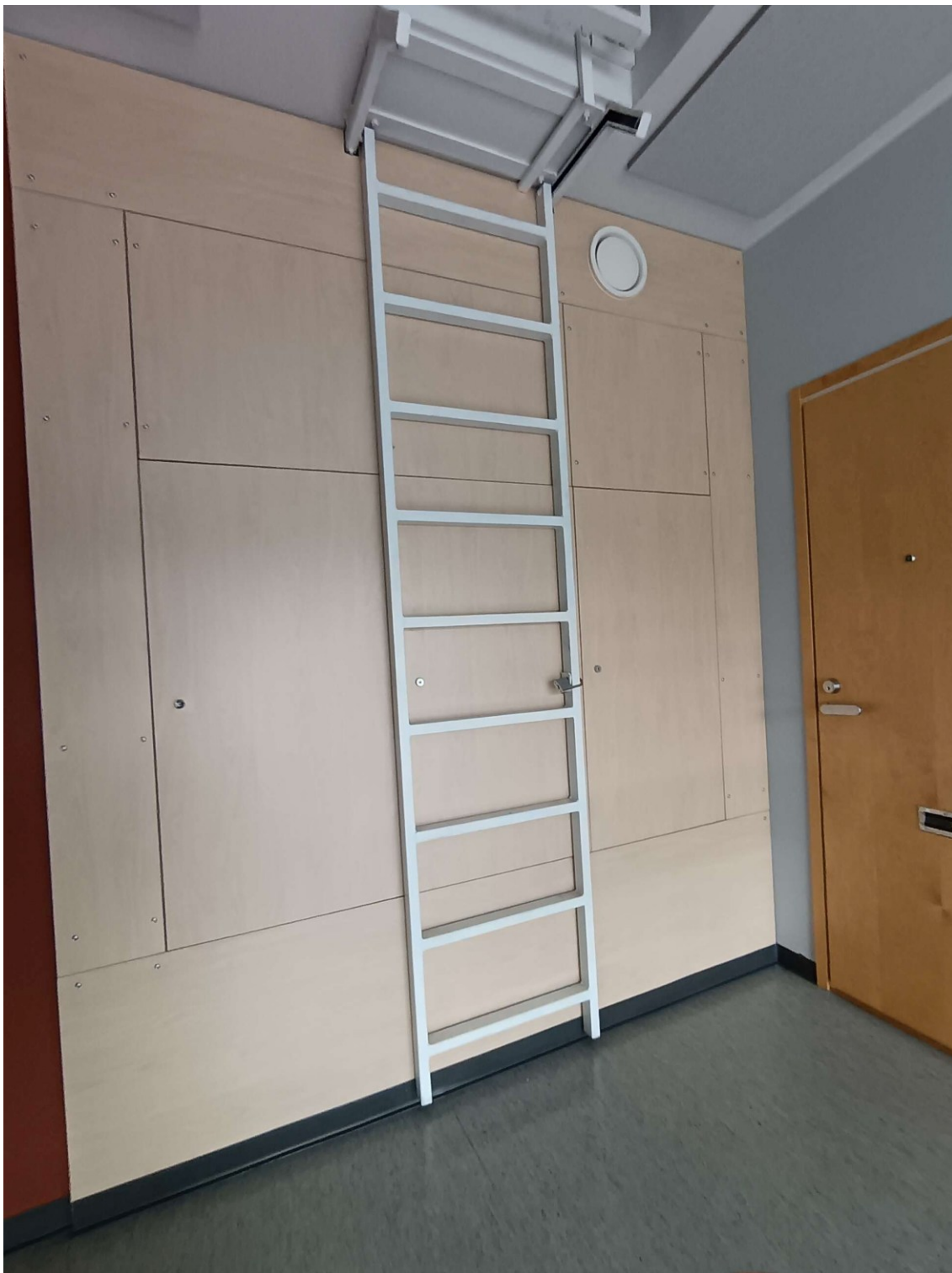
KUVA 10. Jokaisen rakennuksen, joka kerroksen käytävällä on nousukuilulle luukut huoltoa varten.
