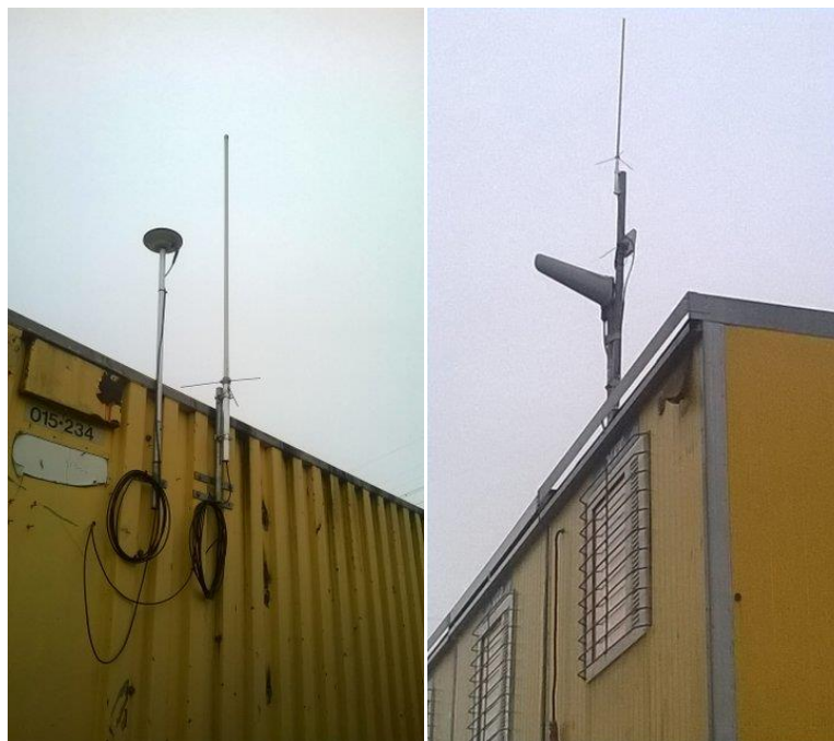
Kuva 15. YIT:n tukiasemakontti, jossa korjaussignaalia lähettävät satelliitivastaanottimet. Joissain laitteistontarjoajilla on käytännössä oma järjestelmänsä. [7.]
