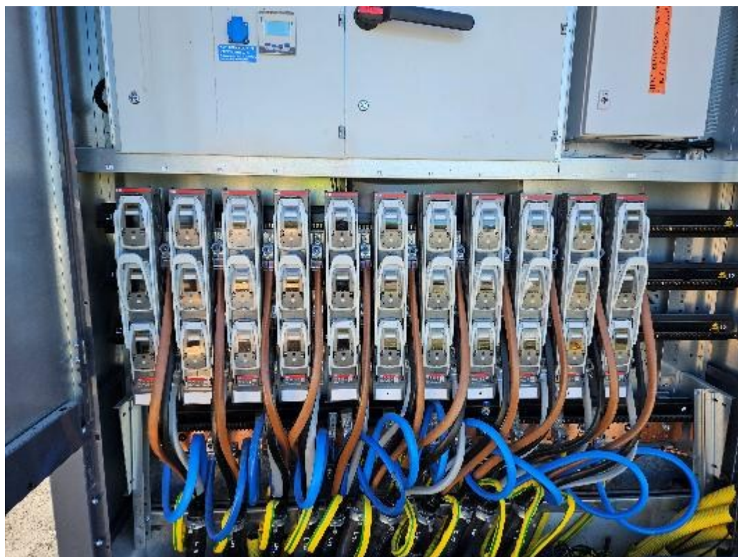
Kuva 12. Linja-autovarikon latausjärjestelmän muuntamon pääkeskus.
