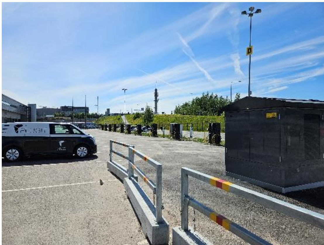
Kuva 6. Sähkölinja-autojen latausjärjestelmä Helsingin Pasilassa.
