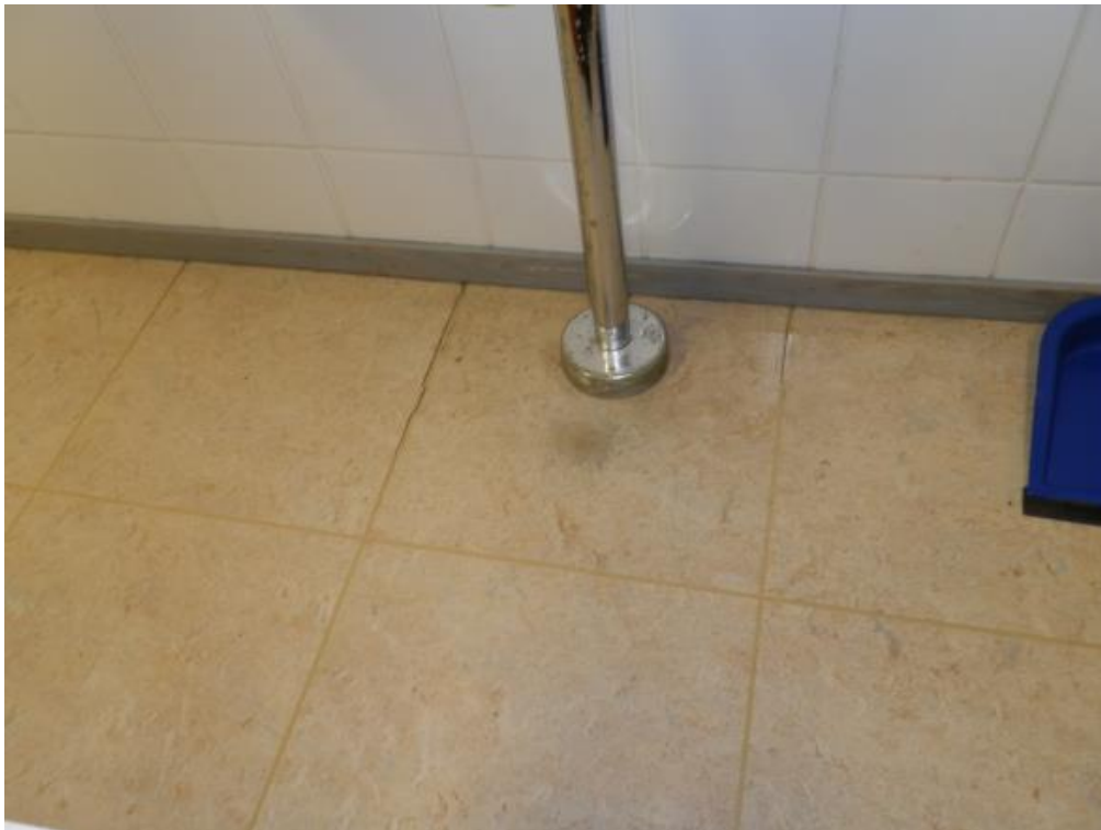
Kuva 12 Ruokailutilan lattiapinnotteessa kosteusjälkiä (Martikainen 2014-12-29.)
