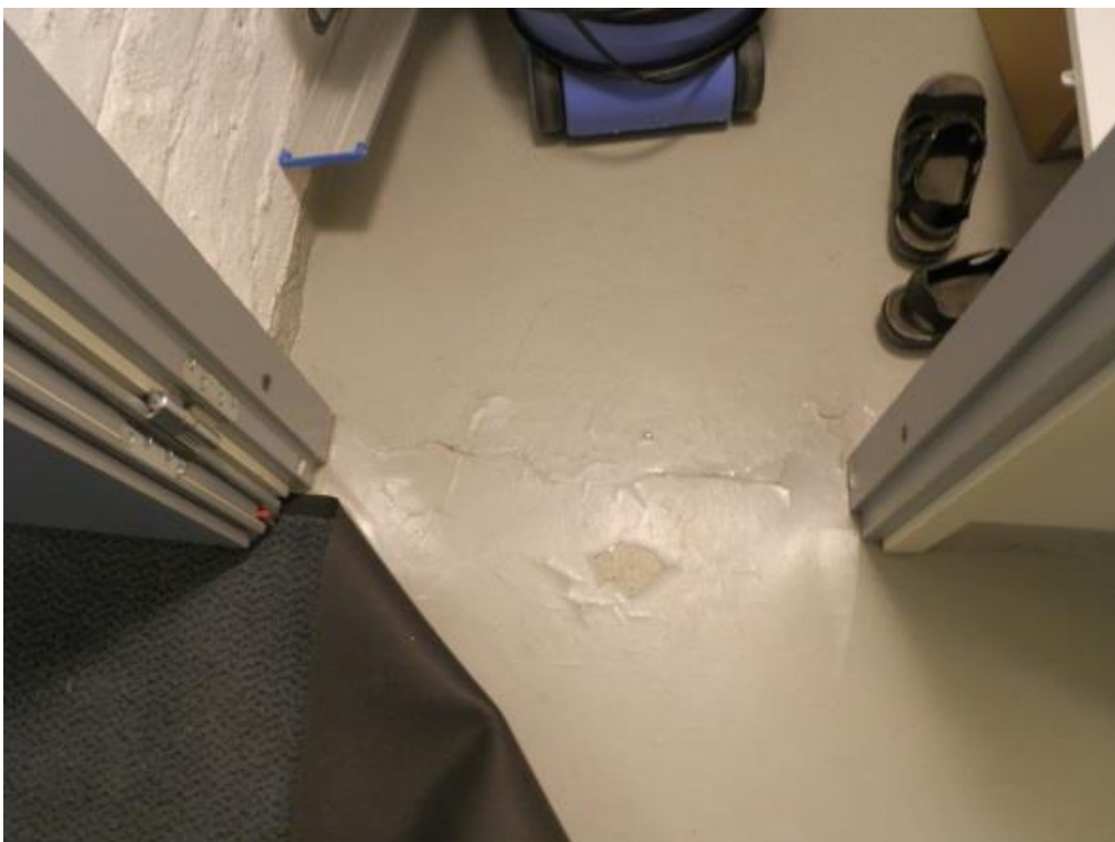
Kuva 5 Lattiapinnan lohkeilu siivousskomerossa (Martikainen 2014-12-22.)
