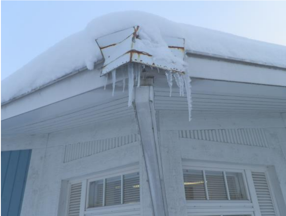
Kuva 9 Räystäskourujen vaurioita (Martikainen 2014-12-29.)
