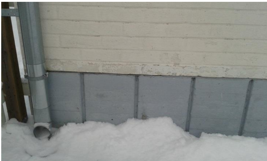
Kuva 9 Ulkoseinän rapautumista (Martikainen 2014-12-22.)
