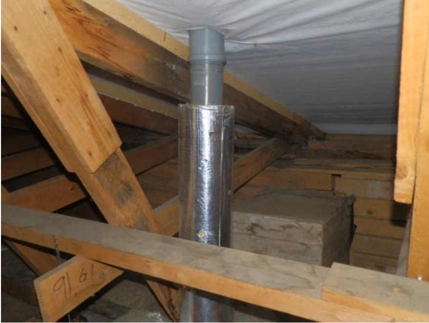
Kuva 6 Tummentumia kattotuoleissa (Martikainen 2014-12-22.)
