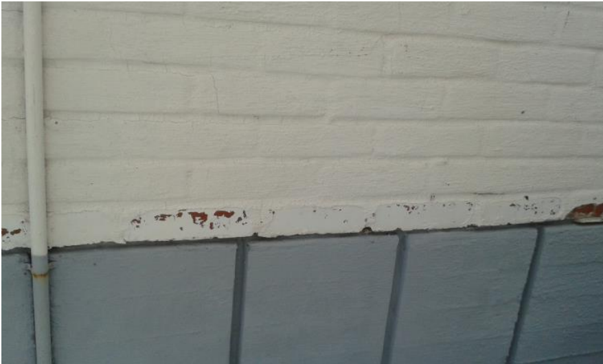
Kuva 10 Ulkoseinän rapautumista (Martikainen 2014-12-22.)
