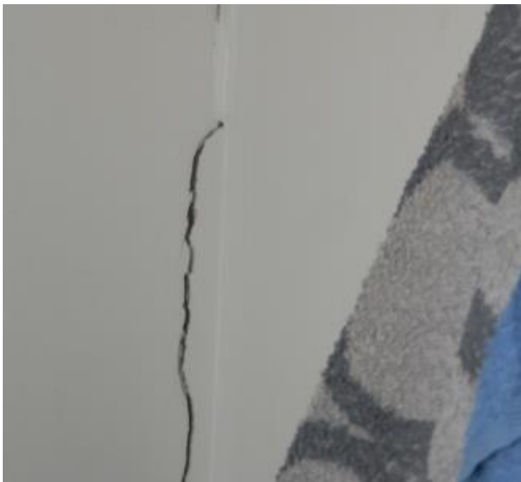
Kuva 15 Halkeamia seinäpinnoissa (Martikainen 2014-12-29.)
