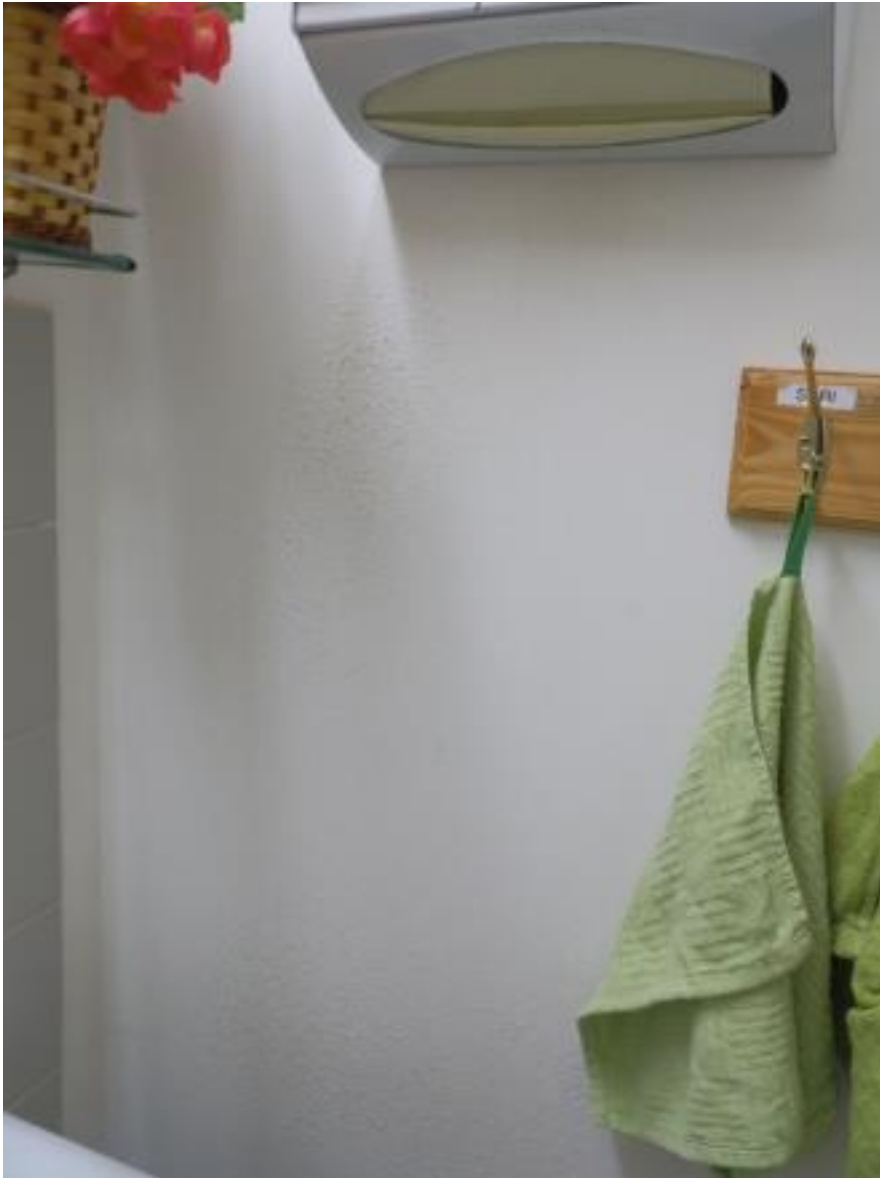
Kuva 21 Maalipinnan hilseily (Martikainen 2014-12-22.)
