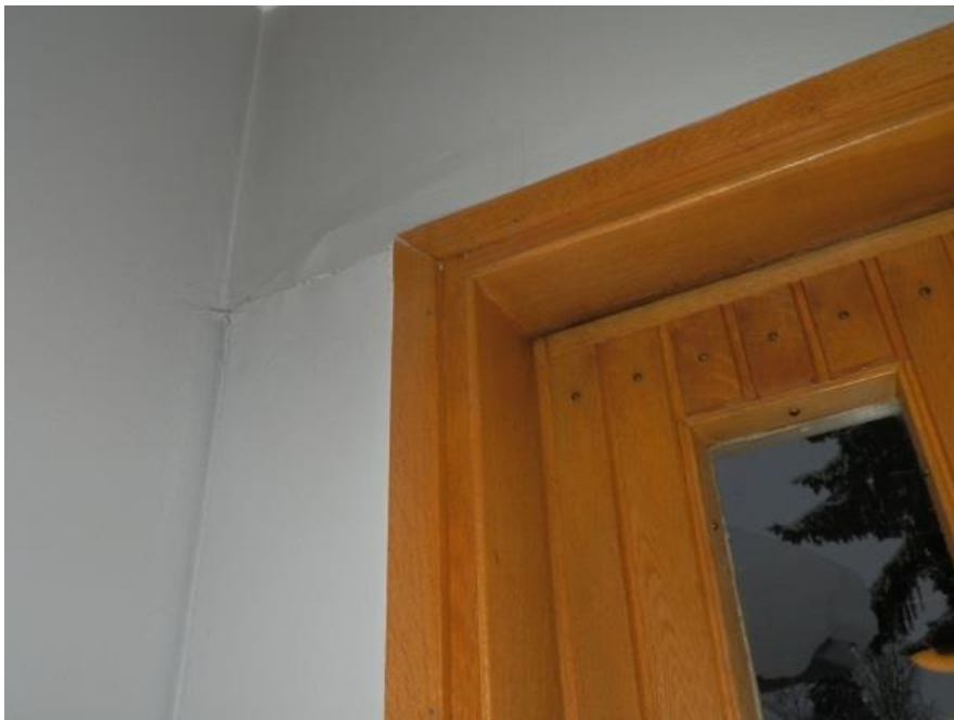
Kuva 20 Seinäpinnan halkeama (Martikainen 2014-12-22.)
