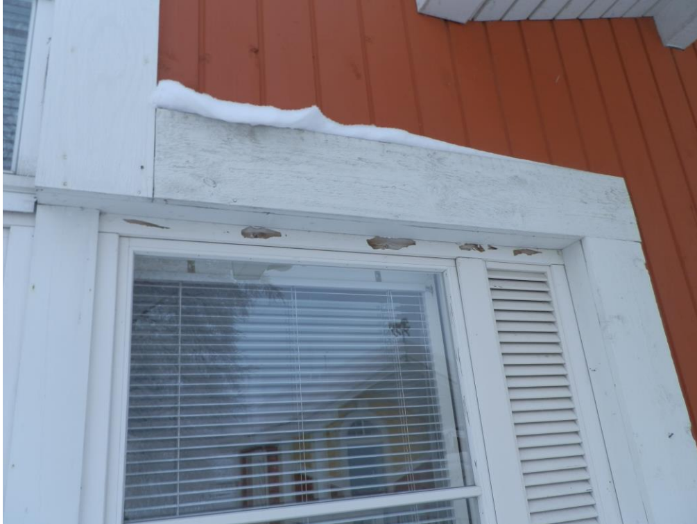
Kuva 8 Pohjoispäädyn ikkunoiden maalipinnan vaurioita (Martikainen 2014-12-29.)
