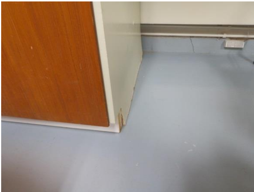
Kuva 23 Kalusteen runko kastunut (Martikainen 2014-12-22.)
