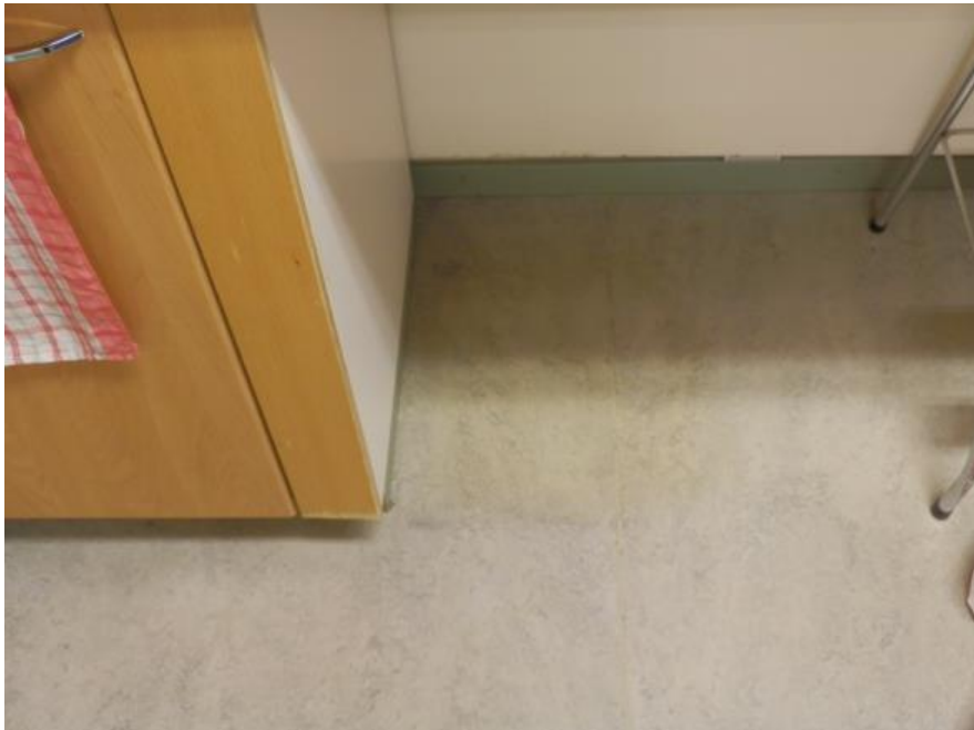
Kuva 16 Astianpesukoneen koreista aiheutuneita kosteusjälkiä (Martikainen 2014-12-22.)
