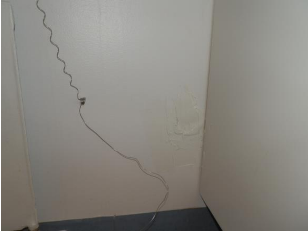
Kuva 7 Paikkausjälkiä keittiön seinässä (Martikainen 2014-12-22.)
