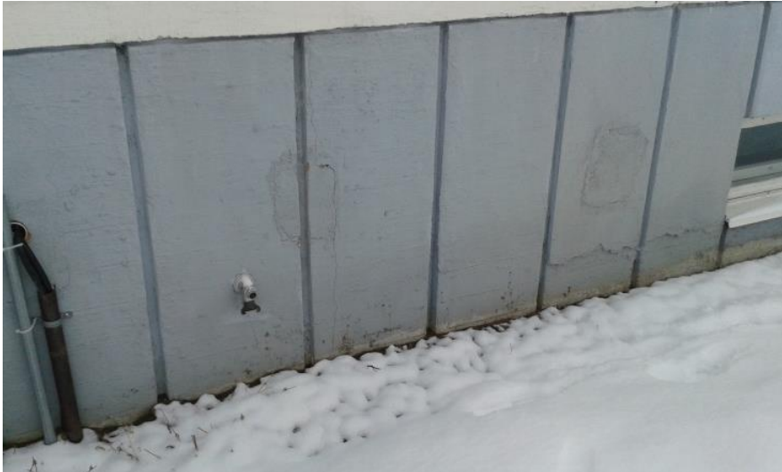
Kuva 4 Paikkausjälkiä sokkelissa (Martikainen 2014-12-22.)
