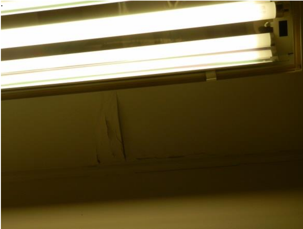
Kuva 24 Suojakupu puuttuu (Martikainen 2014-12-29.)
