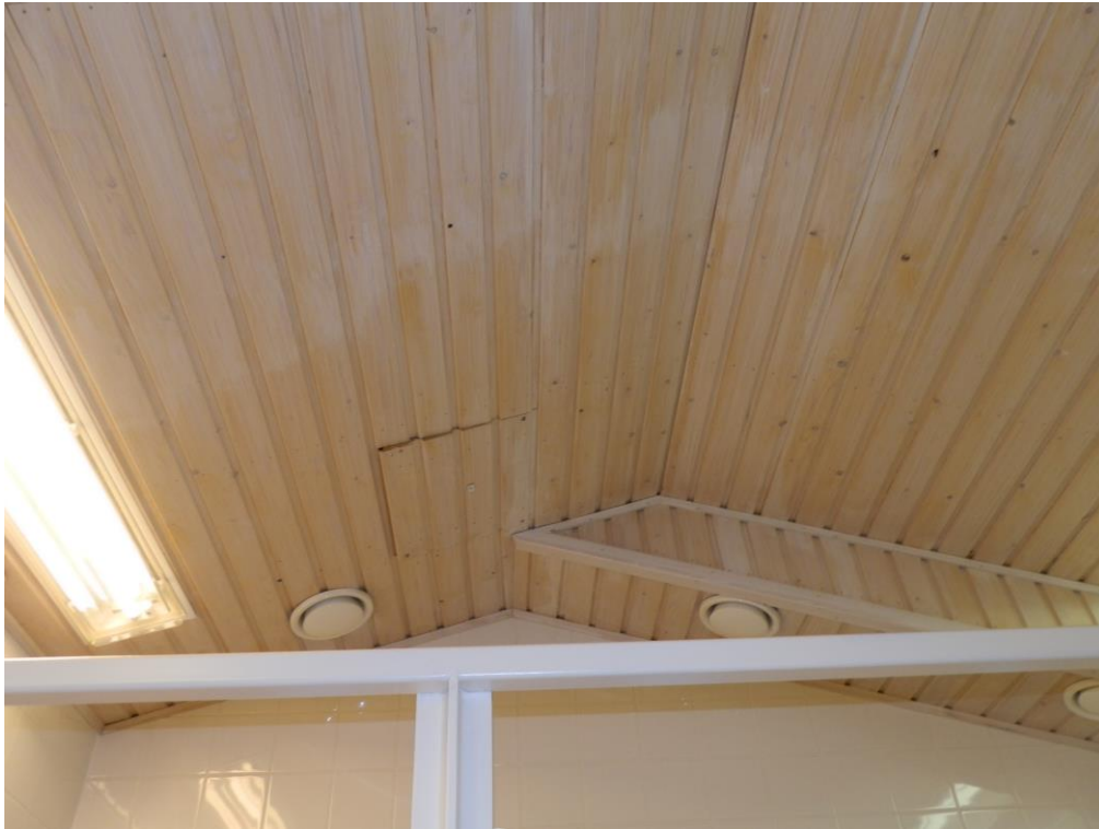
Kuva 14 Huonosti kiinnitetty tarkastusluukku (Martikainen 2014-12-29.)
