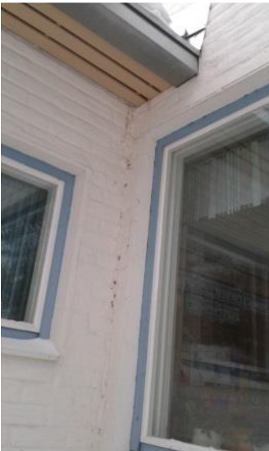
Kuva 11 Ulkoseinän rapautumista (Martikainen 2014-12-22.)
