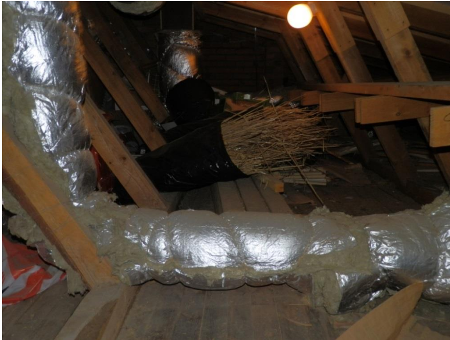
Kuva 8 Ylimääräistä palokuormaa yläpohjassa (Martikainen 2014-12-22.)
