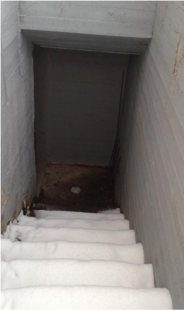
Kuva 5 Kellarikerroksen hätäpoistumistie (Martikainen 2014-12-22.)
