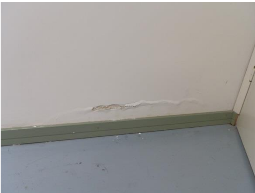
Kuva 22 Seinän lohkeilu askartelutilassa (Martikainen 2014-12-22.)
