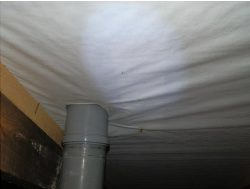
Kuva 7 Aluskatteen läpi työntyneitä nauloja (Martikainen 2014-12-22.)
