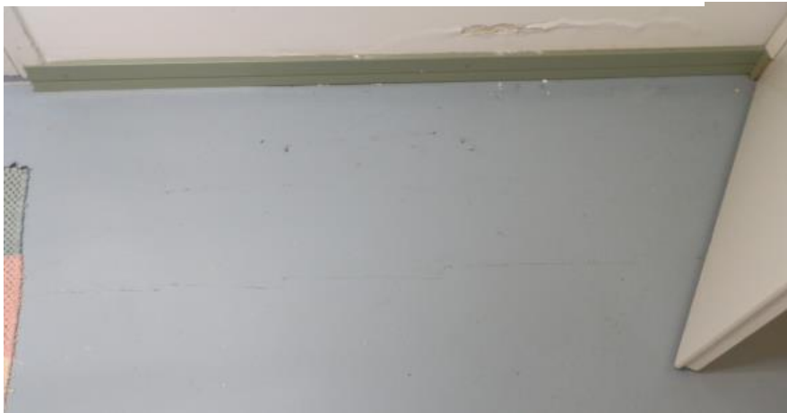
Kuva 18 Halkeamia askarteluhuoneen lattiassa (Martikainen 2014-12-22.)
