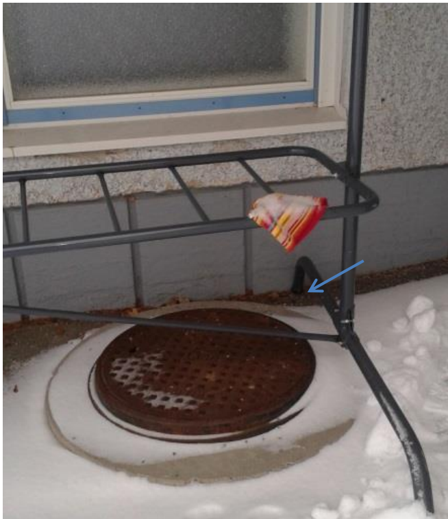
Kuva 1 Painuma asfaltissa (Martikainen 2014-12-22.)
