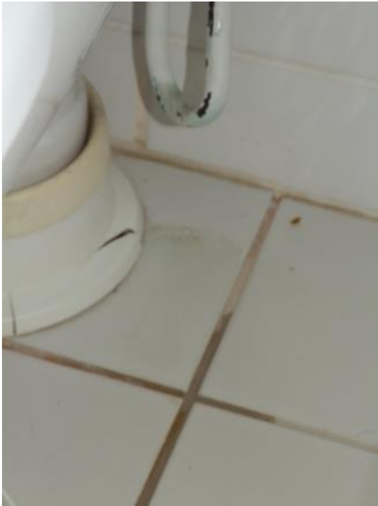
Kuva 19 Vuoto vesijohdon liittimessä (Martikainen 2014-12-29.)
