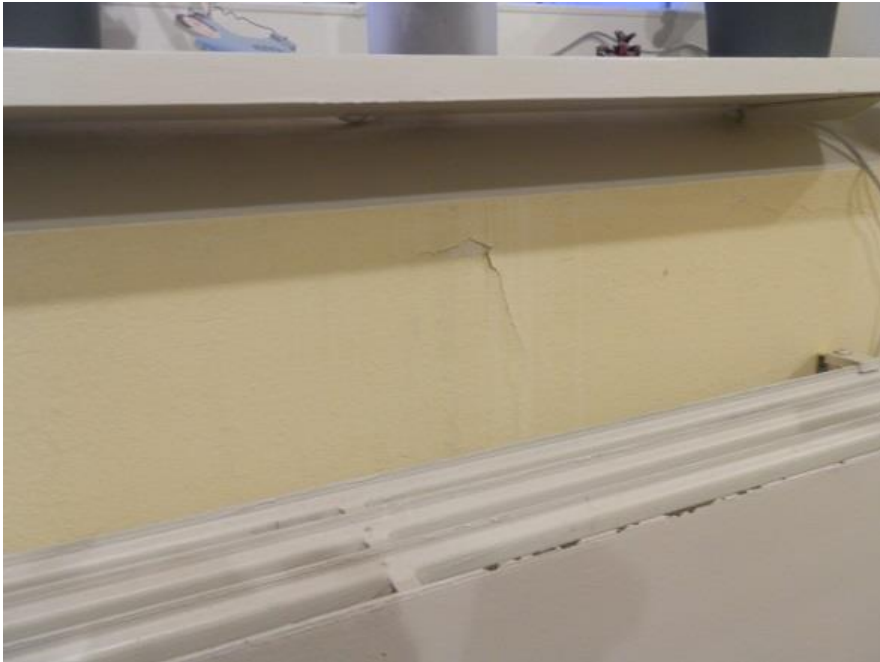
Kuva 19 Maalipinnan lohkeilua (Martikainen 2014-12-22.)
