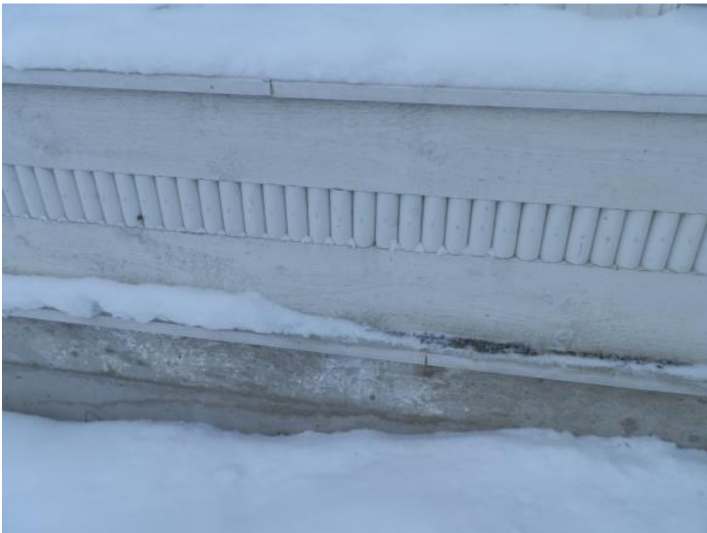
Kuva 5 Sokkelissa kalkkihärmää ja pellityksen päällä sammalta (Martikainen 2014-12-29.)
