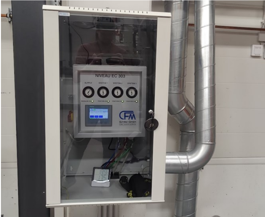
KUVA 5. Laitekaappi ja EC303
