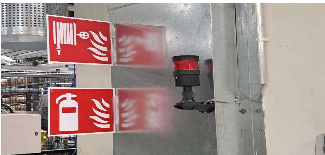
Kuva 20. AGV -vaunujen merkkeamaton häiriömajakka
