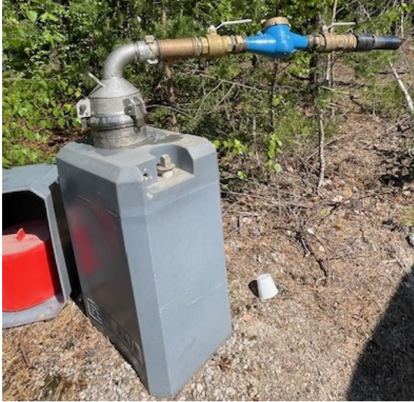
Kuva 1 Maanpäällisen palopostin mittauslaitteisto.
