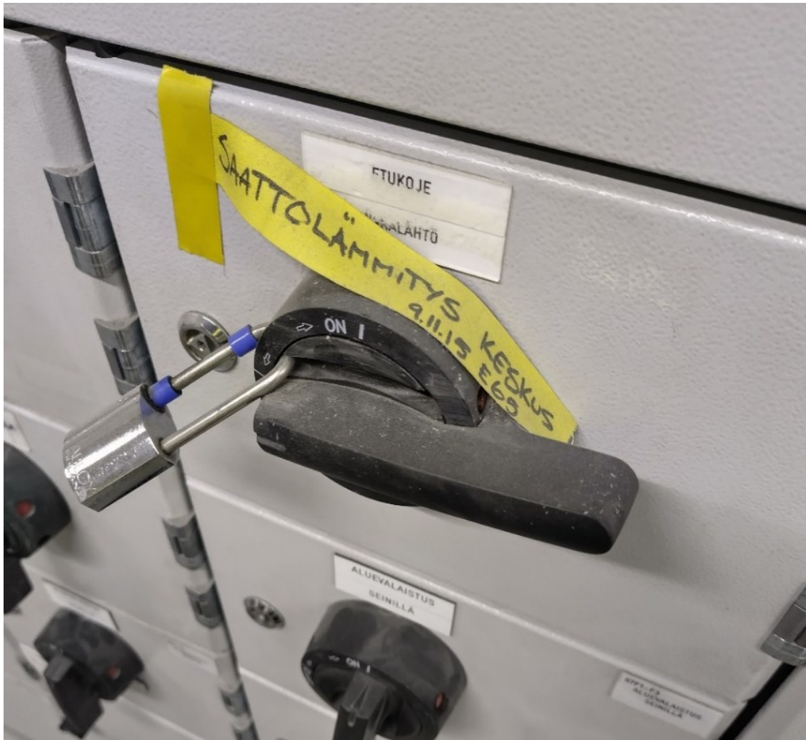
KUVA 6. Saattolämmityskeskuksen syötön katkaisija, joka oli ollut merkintöjen perusteella lukittuna jo vuodesta 2015
