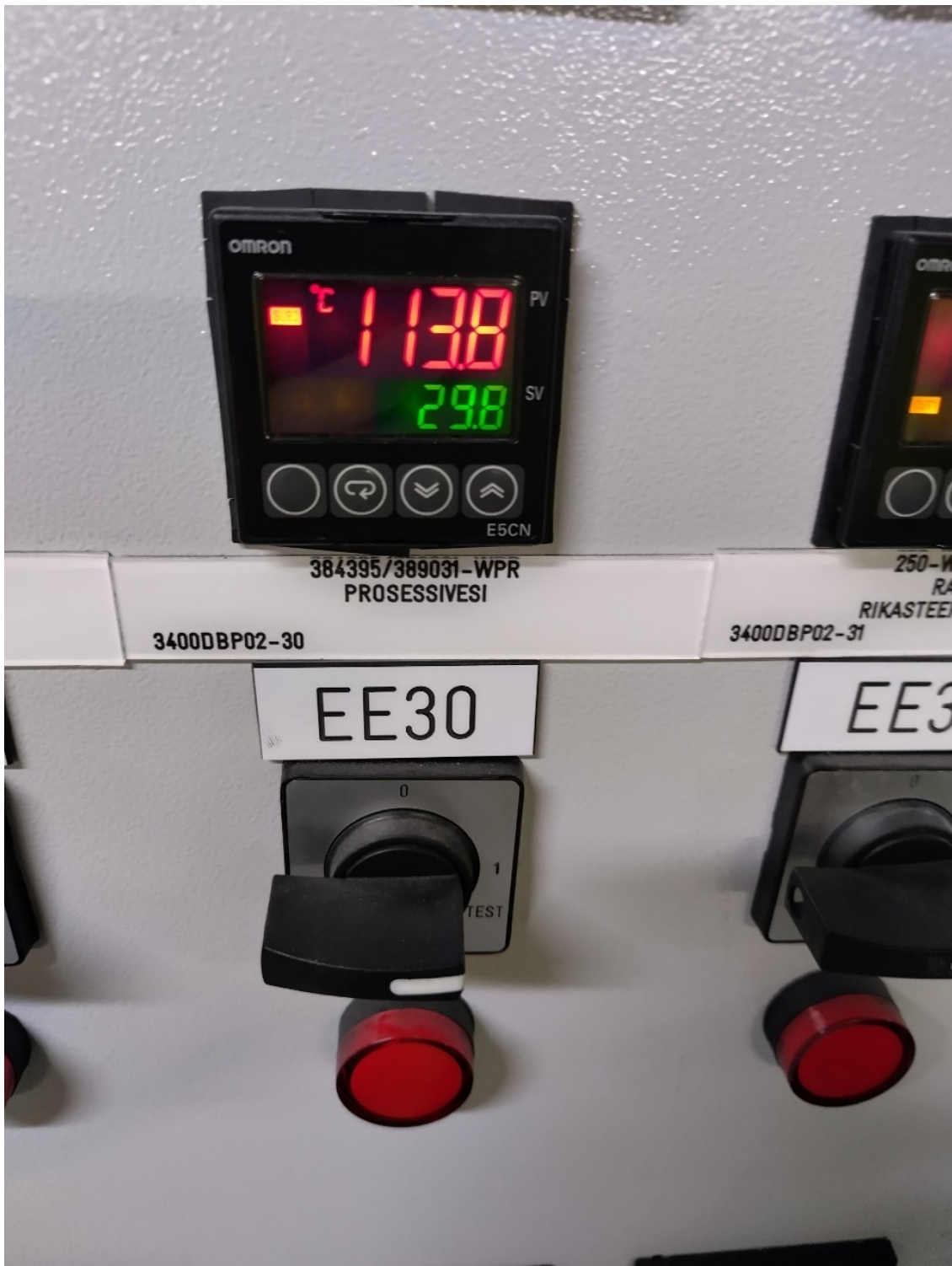
KUVA 10. MCC6-sähkötilassa sijaitsevan 3400DBP02-keskuksen säätimessä ilmoitettu todennäköisesti virheellinen lämpötilatieto, joka voi viitata rikkiiniseen tai väärin kytkettyyn Pt100-anturiin.
