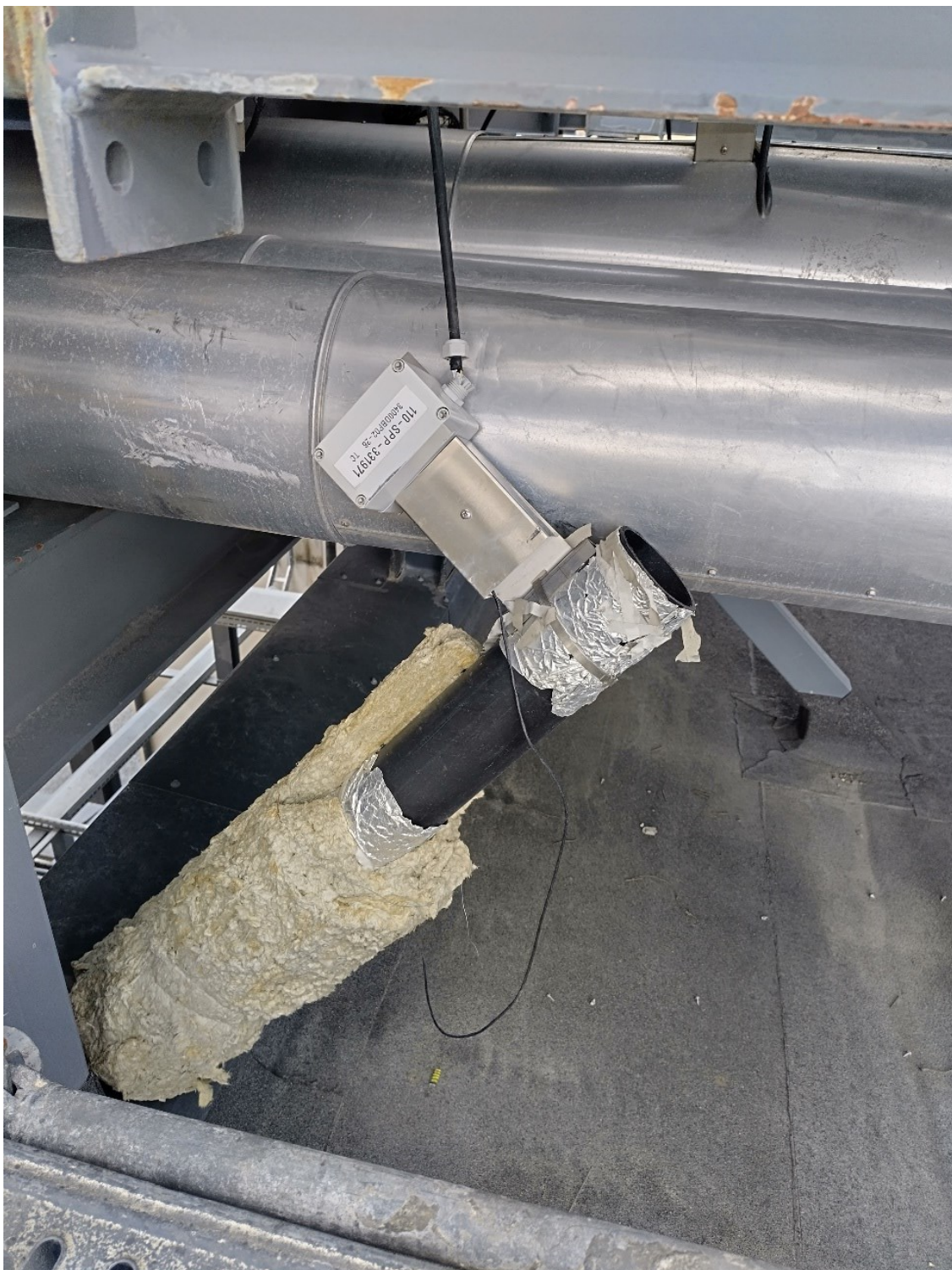
KUVA 16. Sähkösaattolämmitettyjen putkien rikkoutuneita eristeitä
