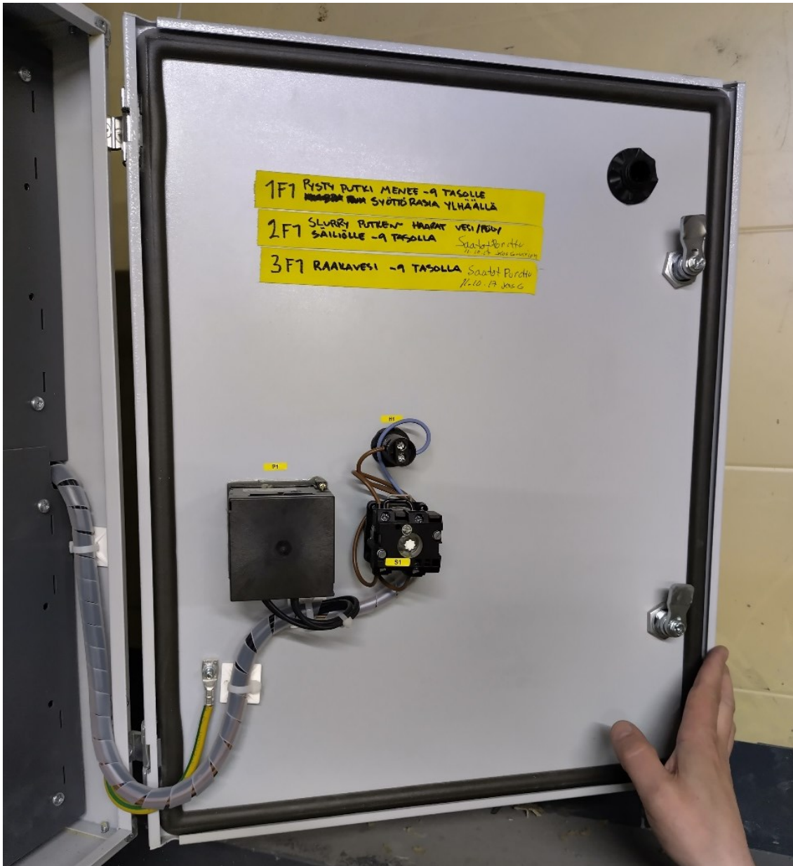
KUVA 7. Saattolämmityskaapin ovi sisäpuolelta. Merkinnän mukaan yksi vaihe olisi vielä käytössä.
