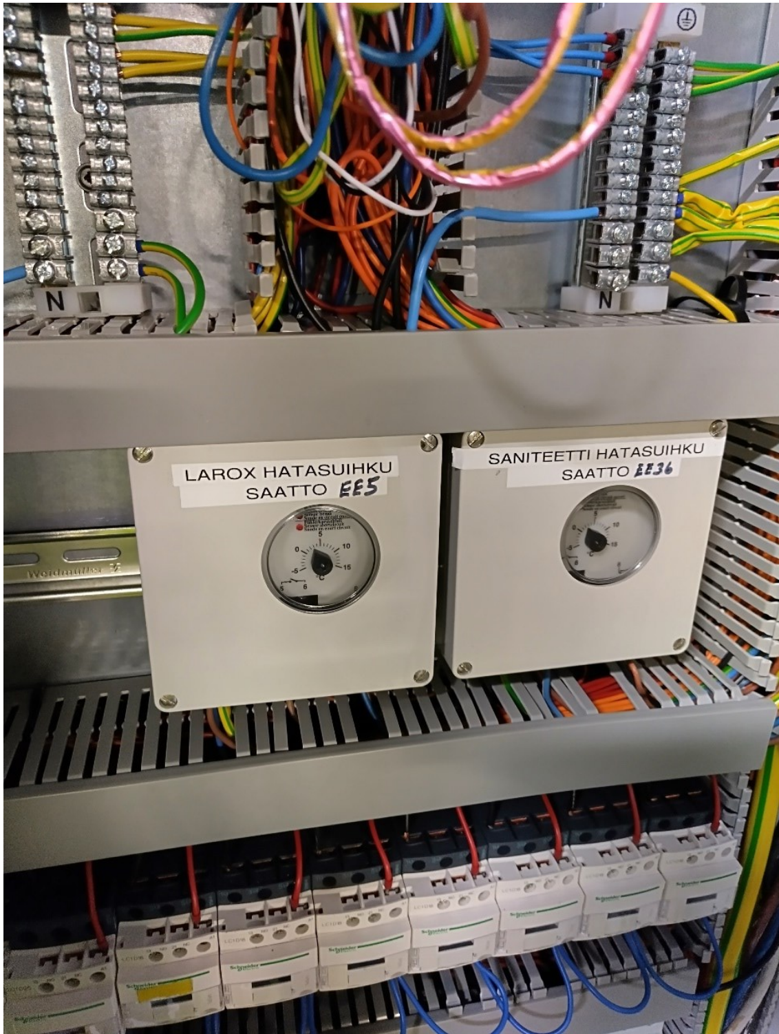
KUVA 14. Normaalista poikkeavaa sähkösaattolämmityslaitteistoa
