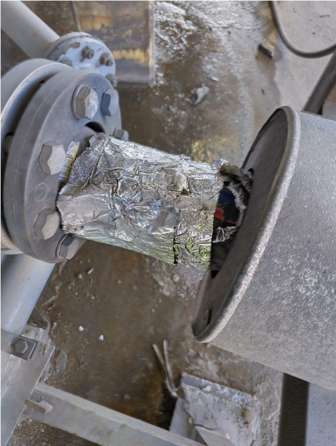
KUVA 18. Lämmityskaapelin heikko lämpöeristys
