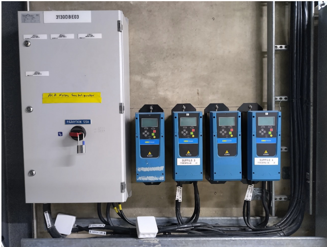
KUVA 24. Esimerkki käyttämättömänä olevasta sähkösaattolämmityslaitteistosta
