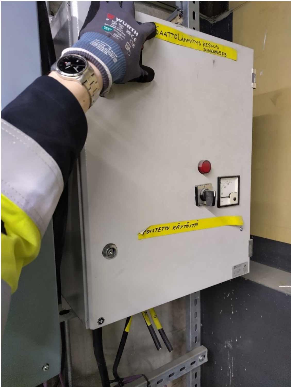
KUVA 5. Sähkösaattolämmityskeskus ulkopuolelta. Kolmesta lähtevästä vaihejohtimesta on katkaistu kaksi. Keskus on poistettu käytöstä vuonna 2015
