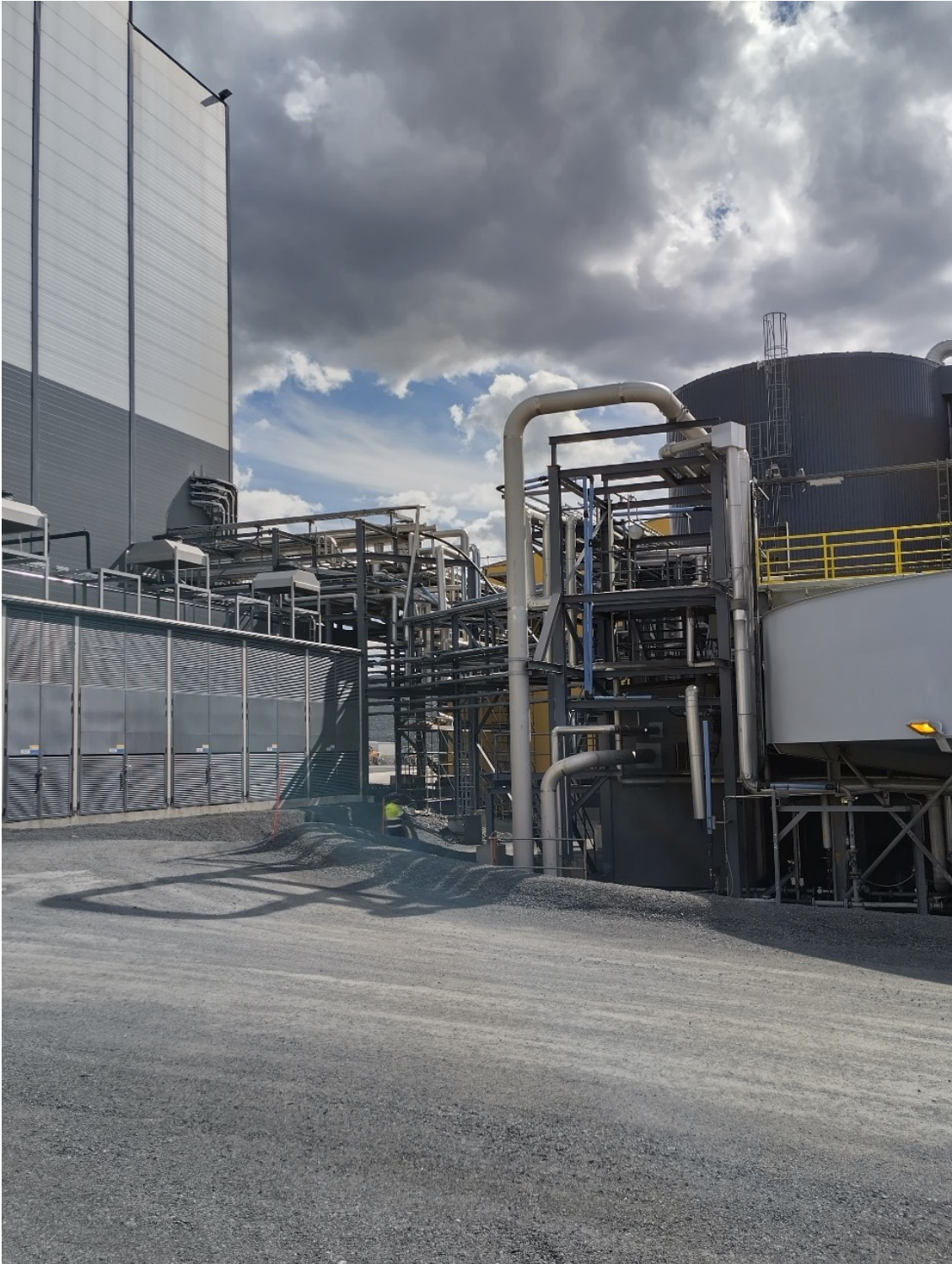
KUVA 15. MCC6-sähkötilan 3400DBP02-keskuksen sähkösaattolämmitysten lämmittämiä putkia
