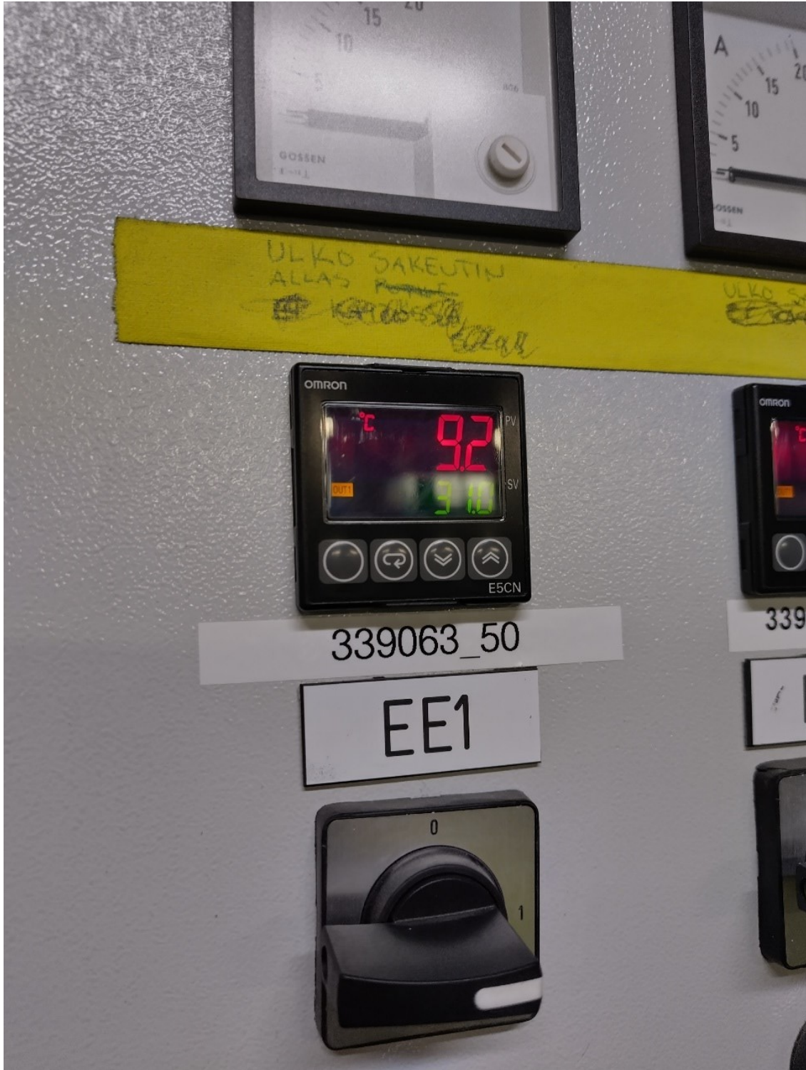
KUVA 20. MCC6-sähkötilassa sijaitsevan 3400DBP02-keskuksen lähtö EE1, joka lämmittää ulkosakeuttimen putkistoa.
