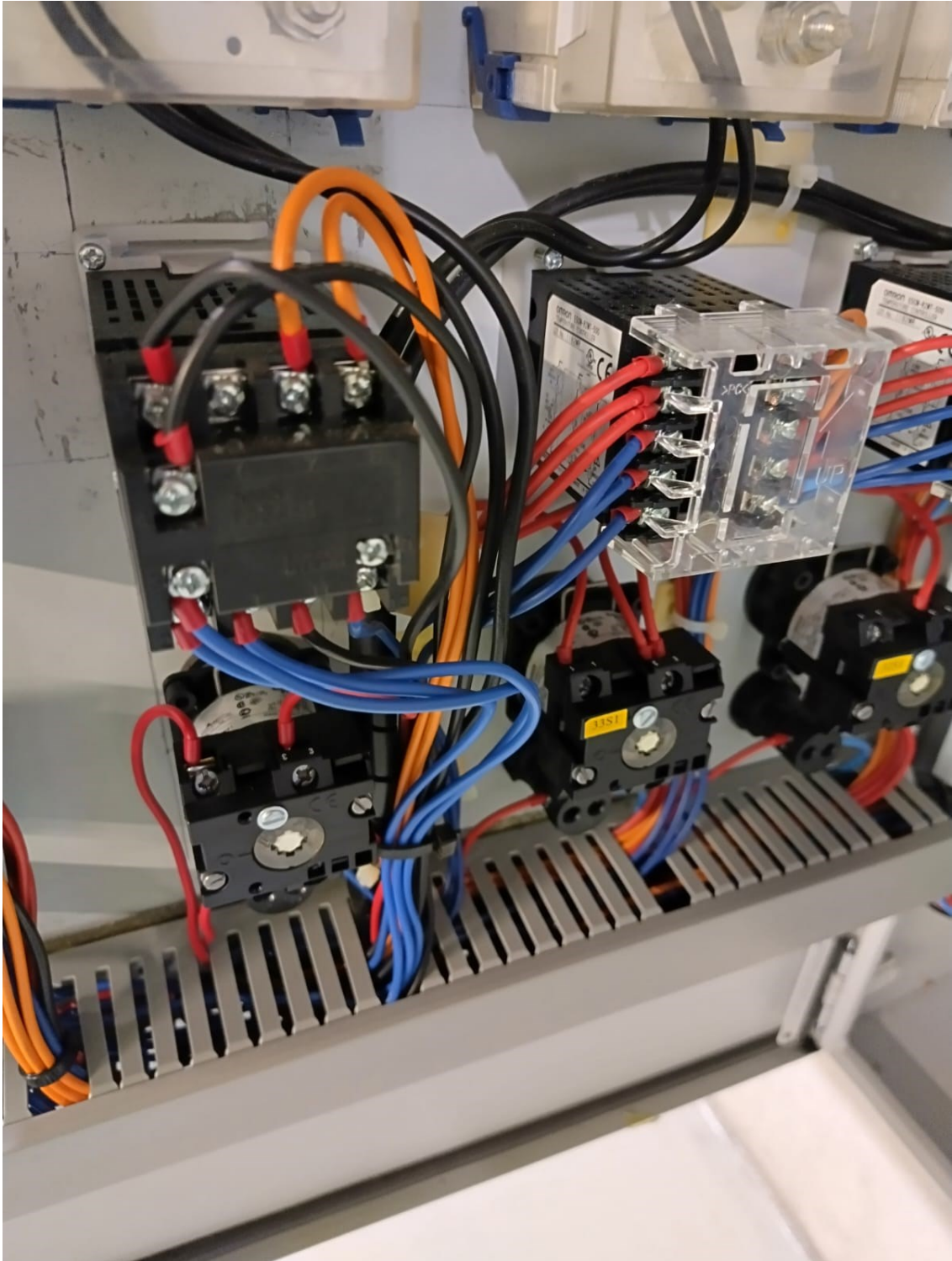
KUVA 12. Rikkinäisiä ja/tai ohitettuja säätimiä. Vasemmalla säädin, jonka suoja puuttuu ja oikealla säädin, jossa se on paikallaan.
