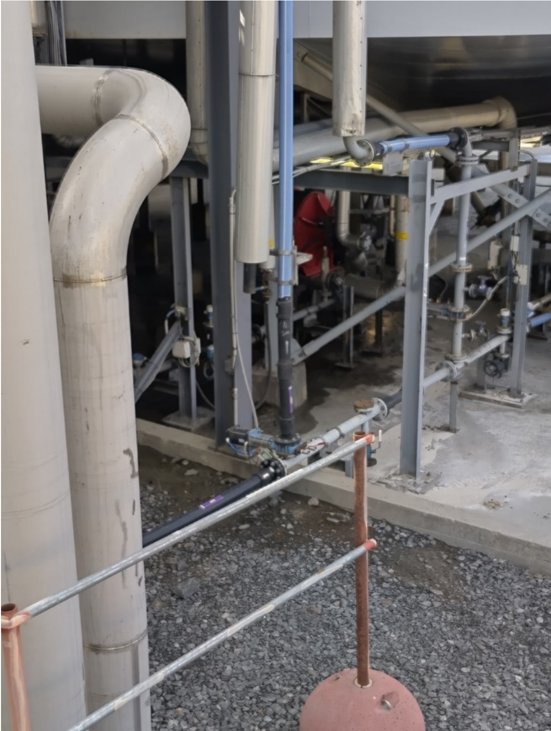
KUVA 19. 3400DBP02-keskuksen EE1 lähdön lämmittämää ulkosakeuttimen putkistoa. Eristeet ovat osittain puutteellisia.
