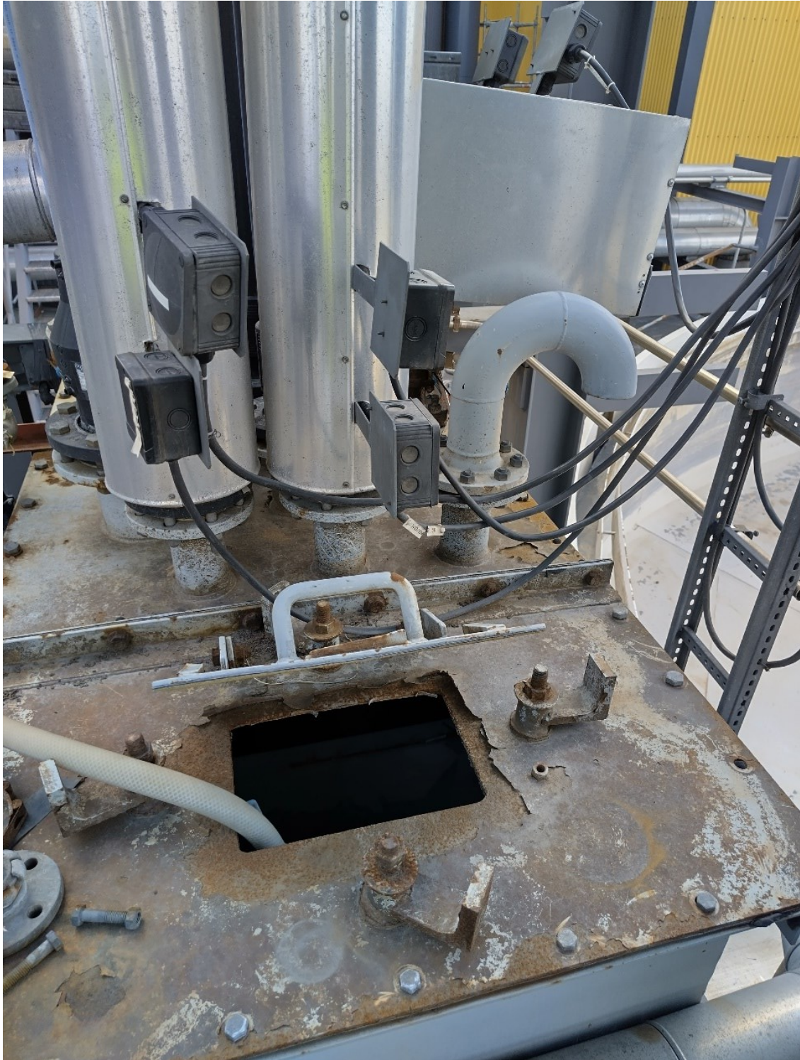
KUVA 21. Oikeassa putkessa olevat 3400DBP02-keskuksen EE1 lähdön Pt100-anturin jakorasia sekä lämmityskaapelin jakorasia.
