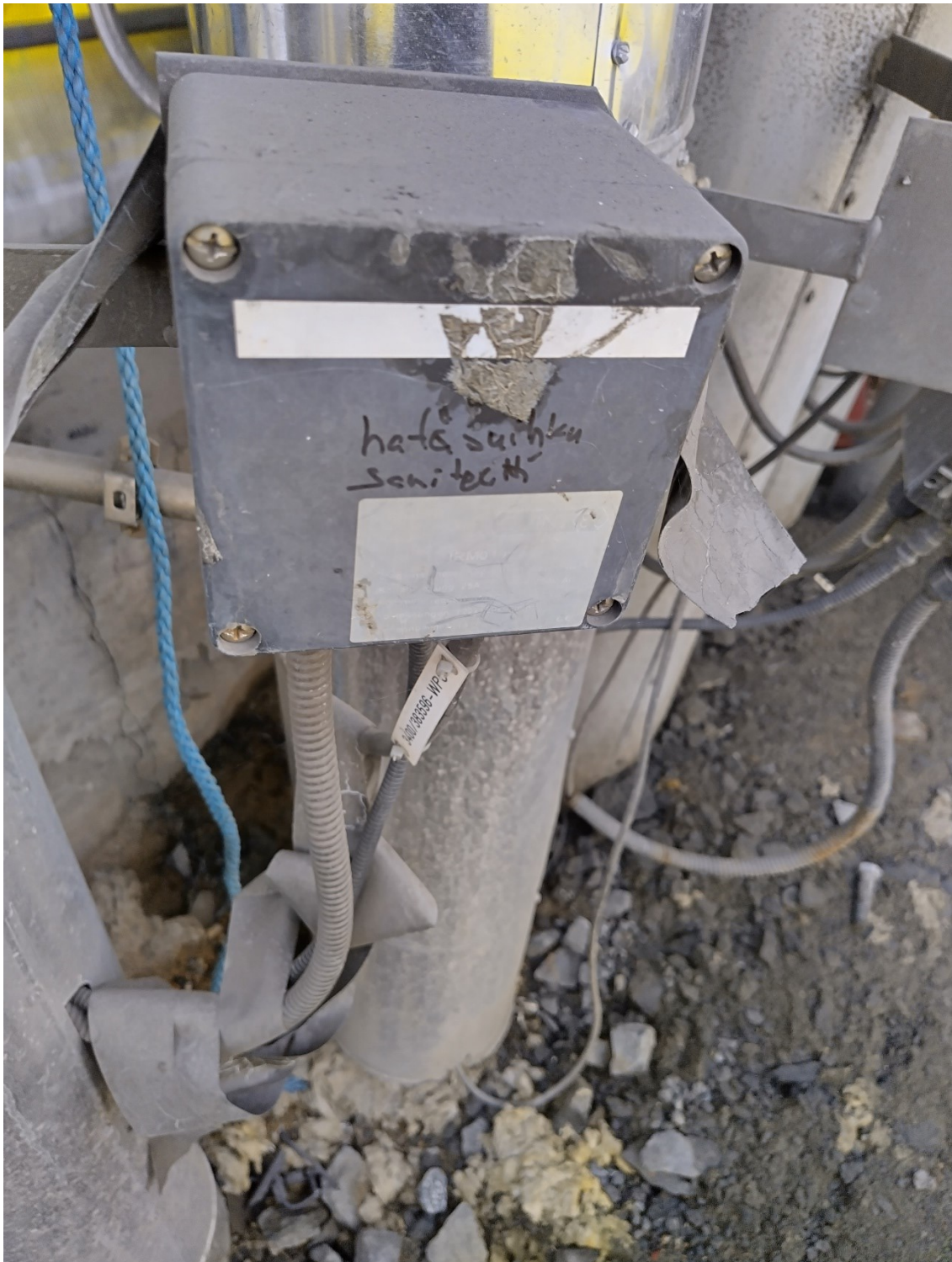
KUVA 17. MCC6-sähkötilan sähkösaattolämmitysten lämmittämien putkien kuluneita jakorasiamerkintöjä
