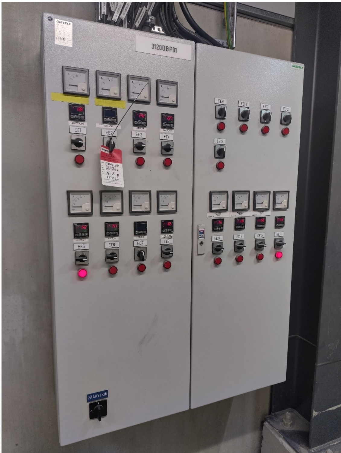
KUVA 8. MCC2-sähkötalassa sijaitseva 3120DBP01-sähkösaattolämmityskeskus
