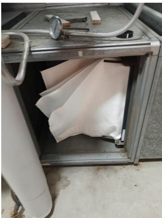
Kuva 7. Ilmanvaihtokoneen uudet suodattimet nuohouksien jälkeen.
