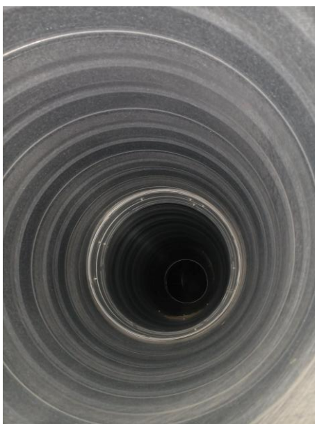
Kuva 5. Kierresaumakanava nuohouksen jälkeen.
