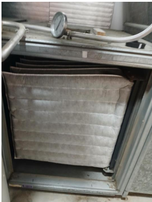
Kuva 6. Ilmanvaihtokoneen suodattimet ennen suodattimien vaihtoa kanava nuohouksien jälkeen.
