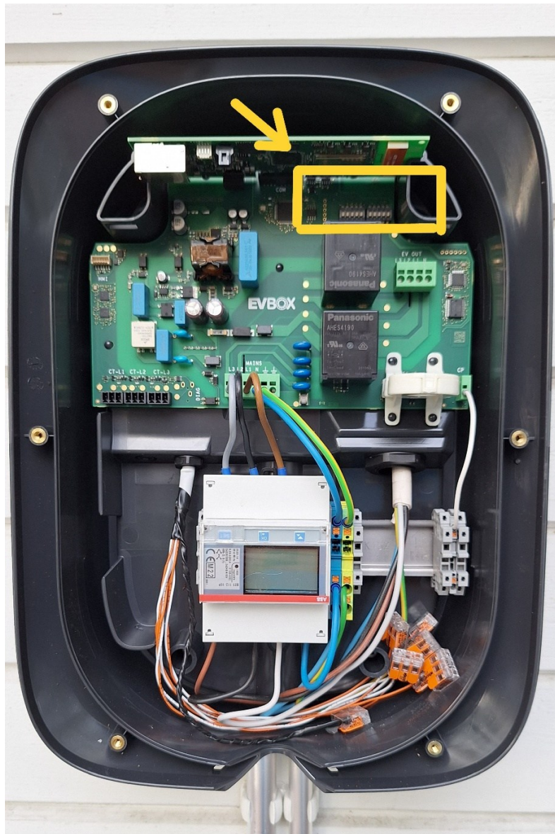
Kuva 3. Sähköauton latausaseman staattinen kuormanhallinta.
