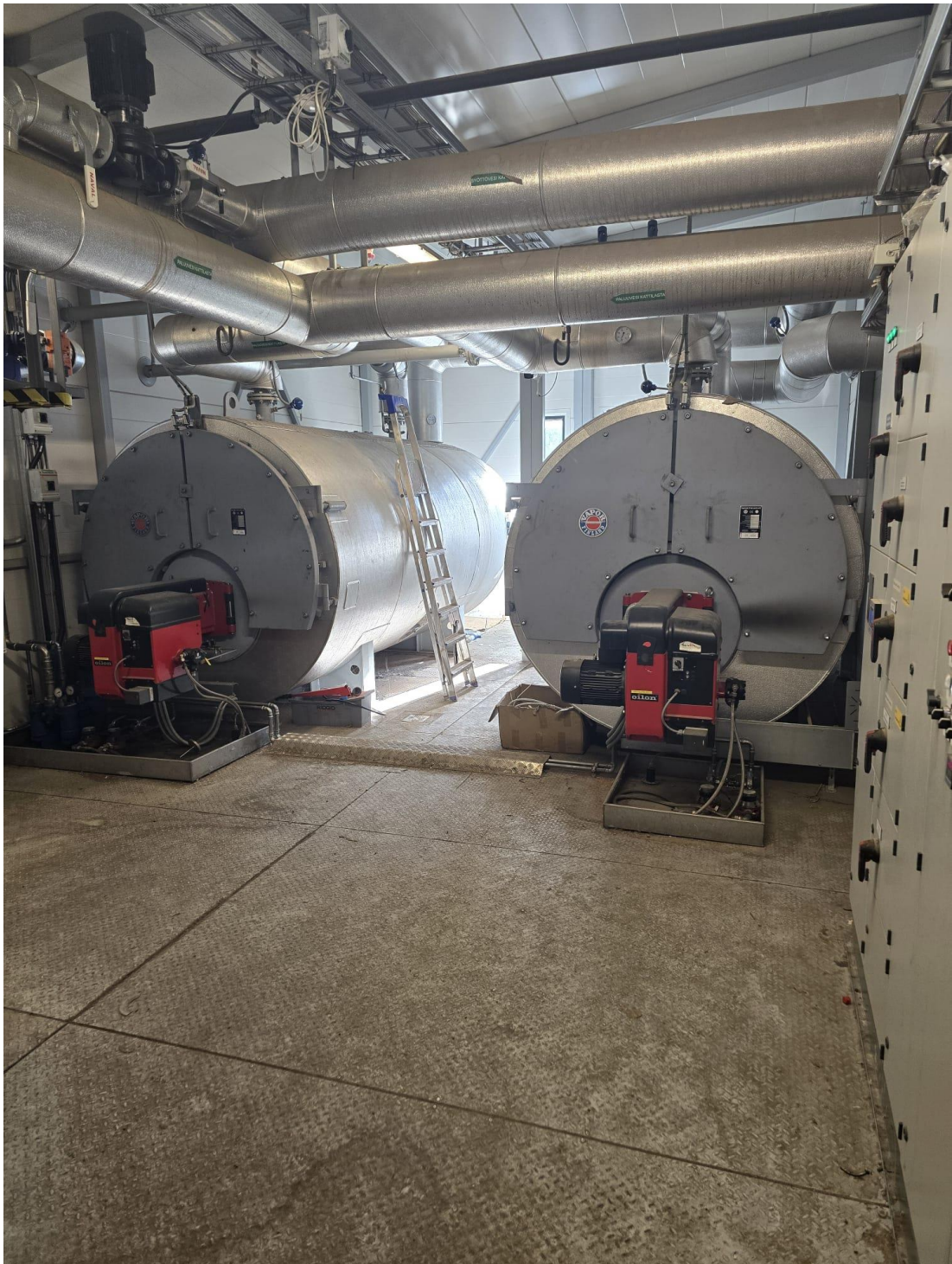
Kuva 3. Purson öljypolttimet ja kattilat (Juho Kuusikoski, 2025)
