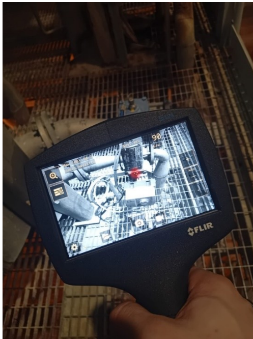
Kuva 31 FLIR Si124 akustisella vuotokameralla havaittu paineilmavuoto toimilaitteessa.
