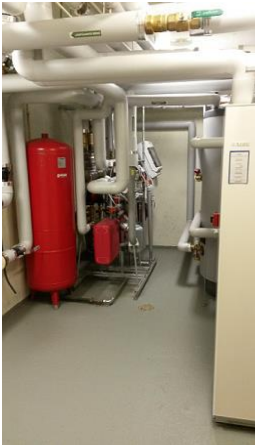
KUVA 2. Pohjolankadun lämmönjakohuone (Kuva: Mikael Lehtinen 2015)
