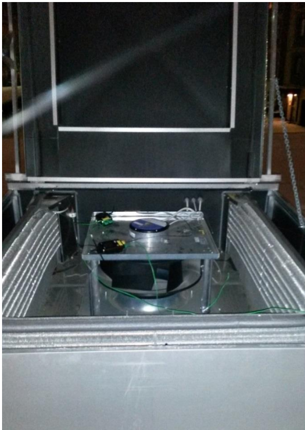
KUVA 4. Poistoilman lämpötilamittaus LTO-huippuimurista (Kuva: Mikael Lehtinen 2015)
