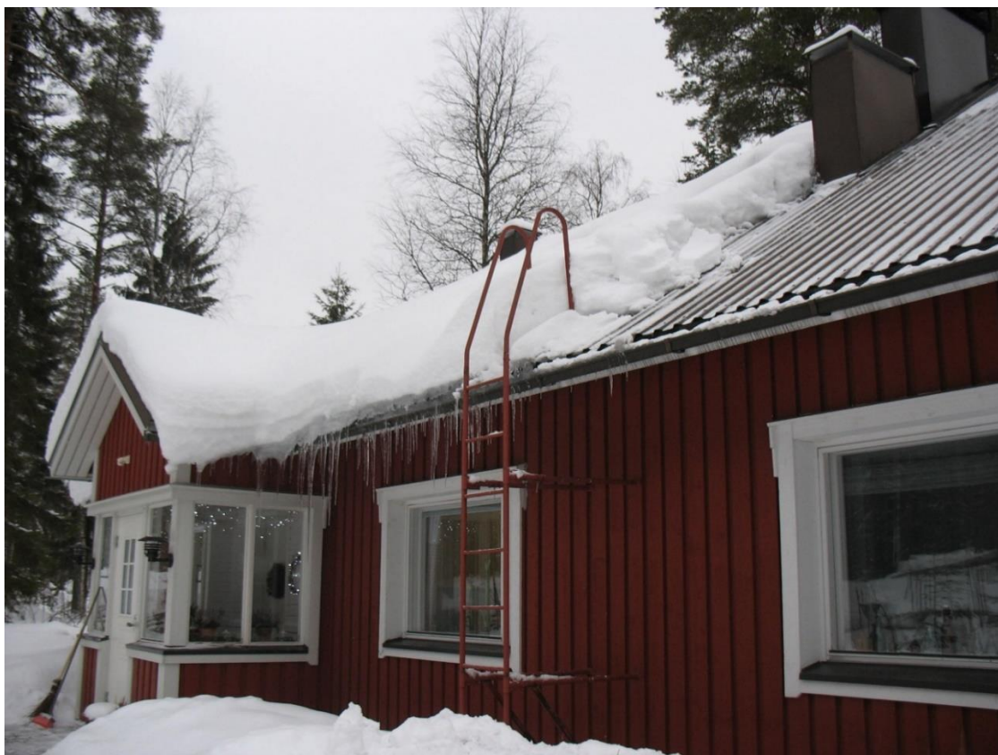
KUVA 10. Jää on kertynyt räystäälle kattoikkunoiden kohdalla (Esa Pääkkönen 2015)
