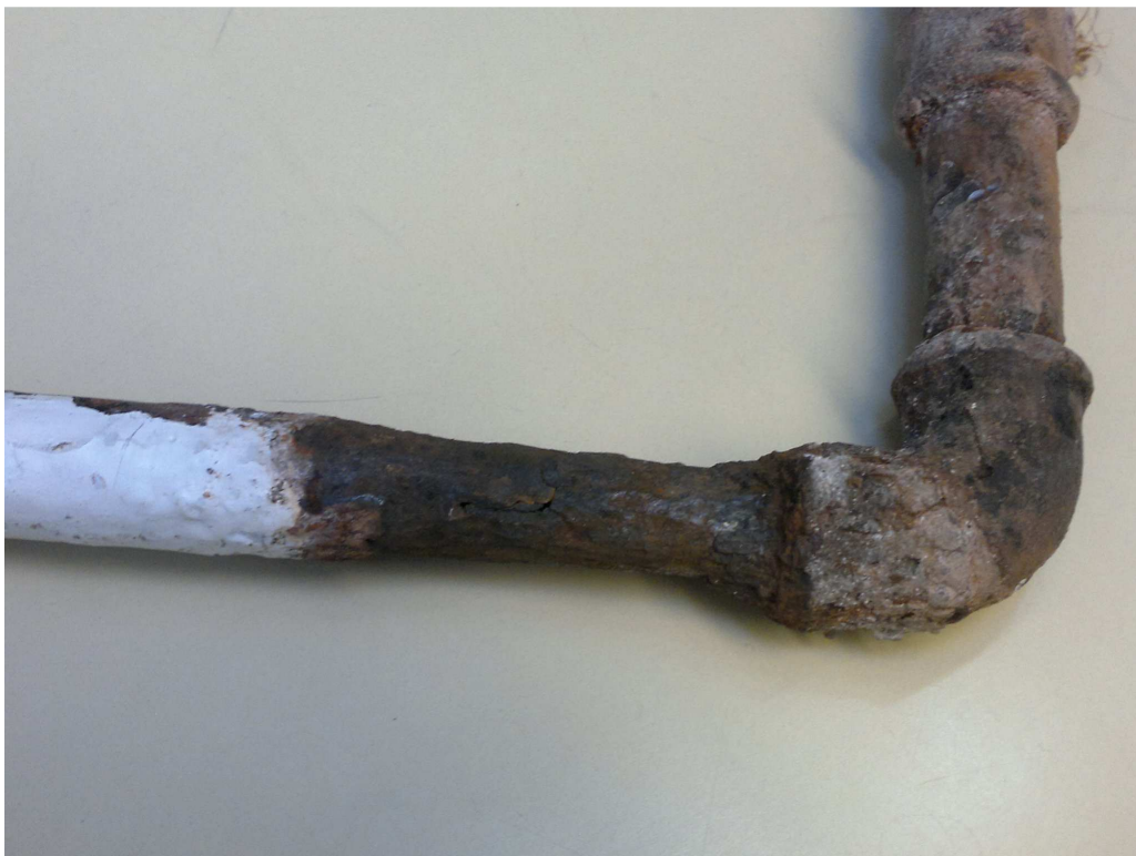
LVI-kuva 8. Kolmannen kerroksen vessasta poistettu patteriputki.
