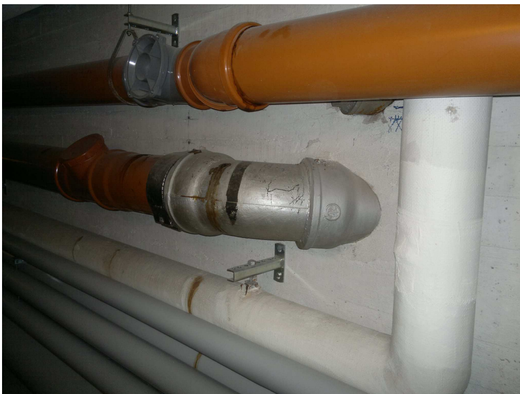
LVI-kuva 13. 90-luvulla uusitut pohjaviemärit ja liitos alkuperäiseen tonttivismäriin.
