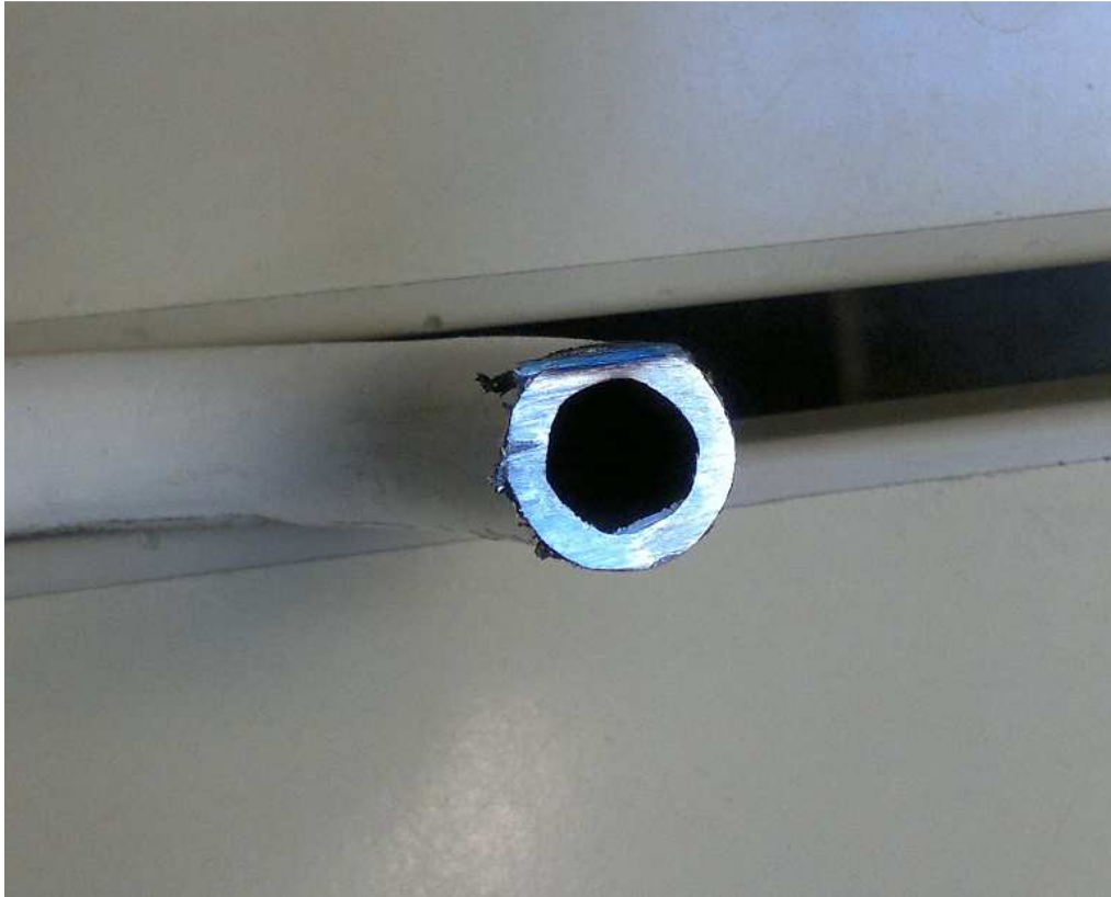
LVI-kuva 7. Ensimmäisen kerroksen vessan patteriputken kunto.
