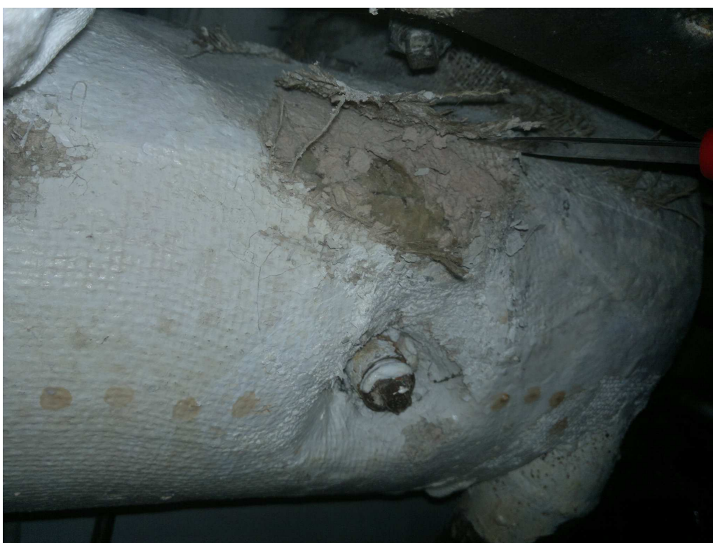
LVI-kuva 10. Lämmitysputken eriste, joka sisältää asbestia.
