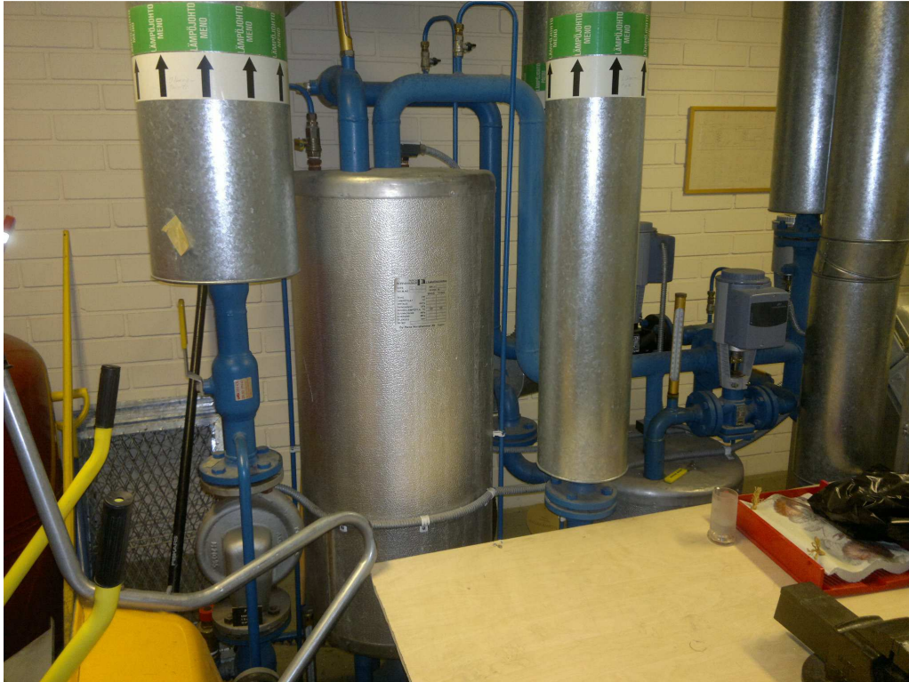
LVI-kuva 3. Lämmitysjärjestelmän lämmönsiirrin alueella 2.
