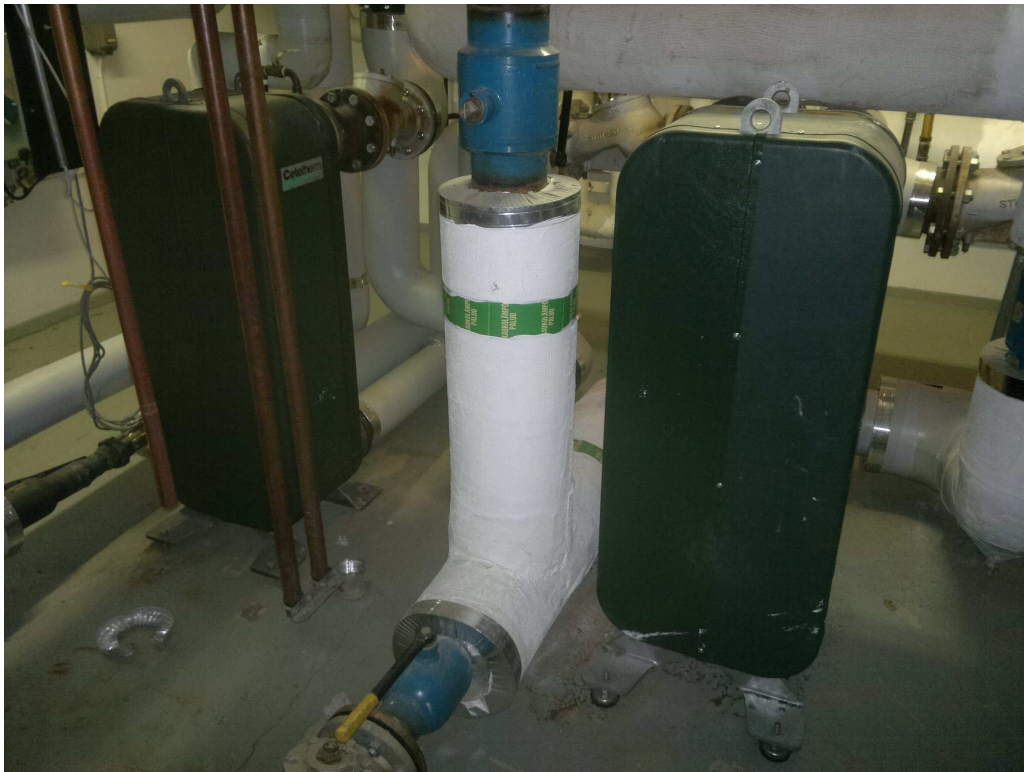
LVI-kuva 1. Lämmitysjärjestelmän lämmönsiirtimet alueella 1.
