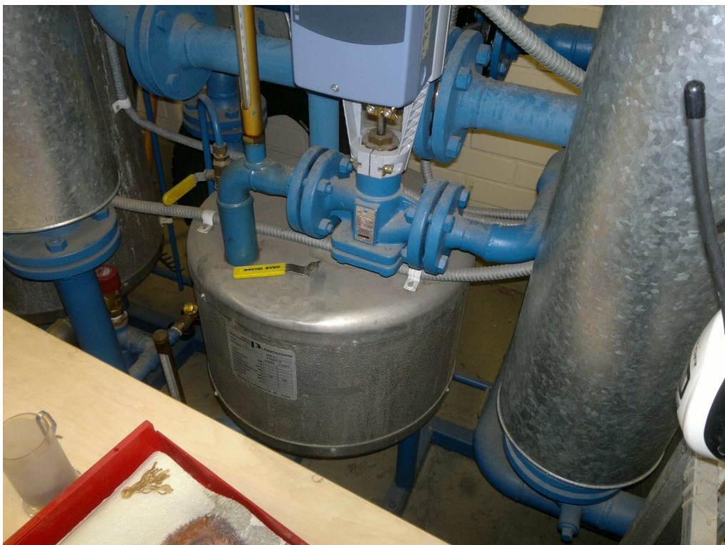
LVI-kuva 4. Käyttöveden lämmönsiirrin alueella 2.
