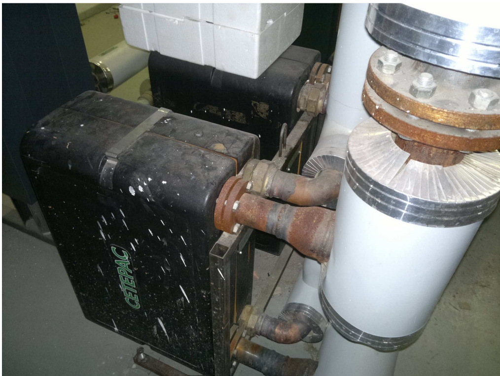
LVI-kuva 2. Käyttöveden lämmönsiirtimet alueella 1.
