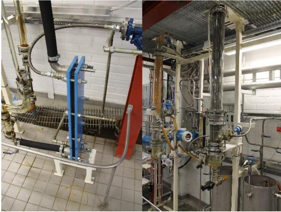
KUVIO 11. Laitteiston pohjakiehutin ja lämmönvaihdin
