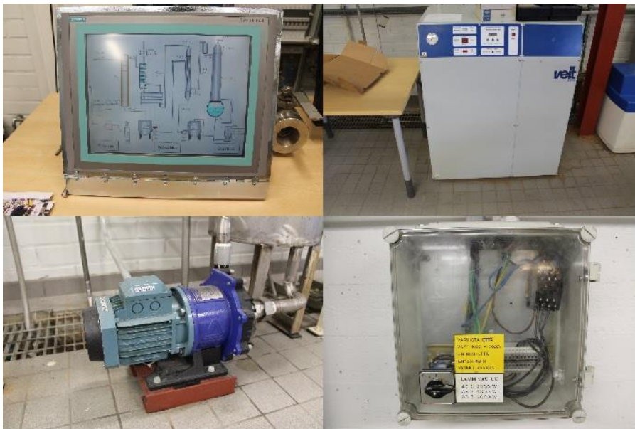
KUVIO 10. Laitteiston näyttöpäätte, höyrynkehitin, pumppu ja esilämmittimen säätöpaneeli
