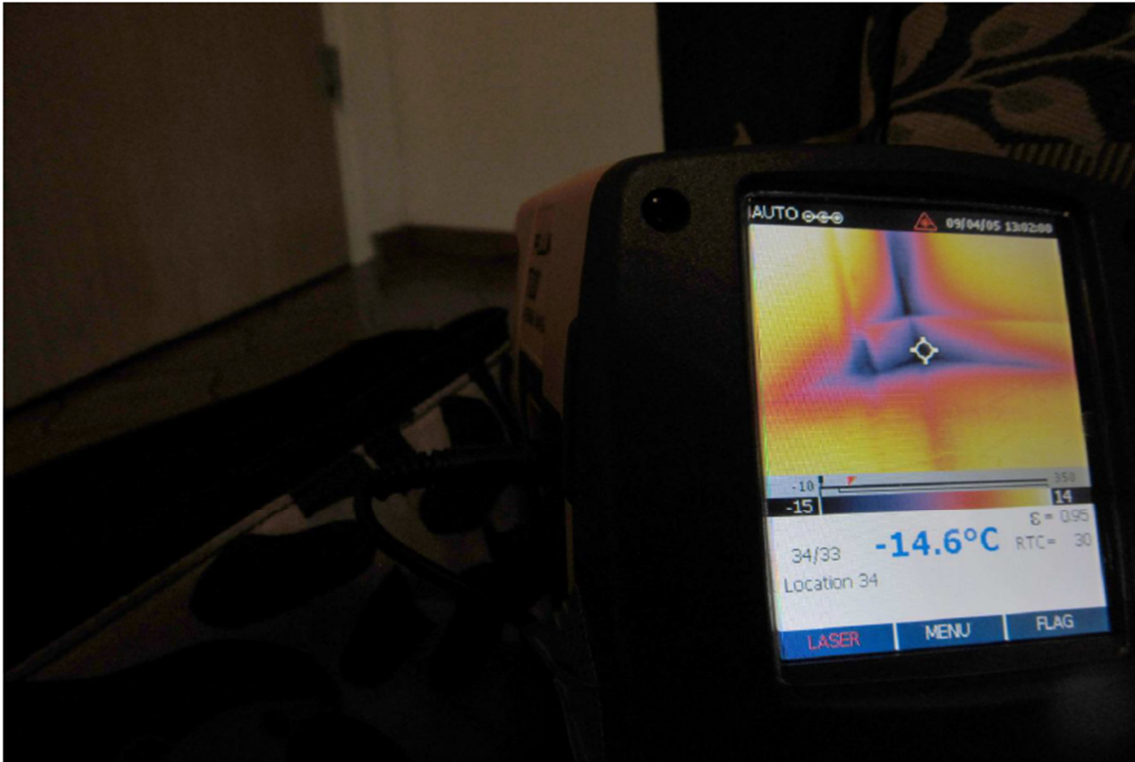
KUVA 2. Yläkerran vessan ovenpieli, pakkasta -15 °C (2)
