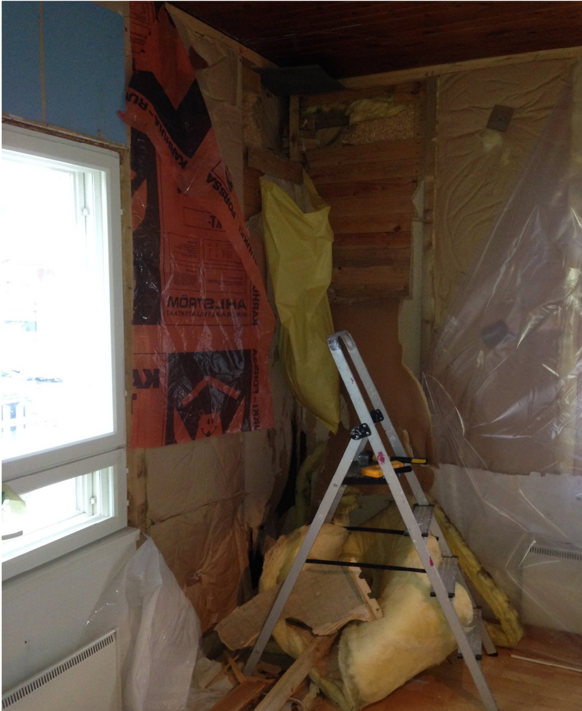
KUVA 9. Vääristä materiaaleista huolimattomasti tehty höyrynsulku
