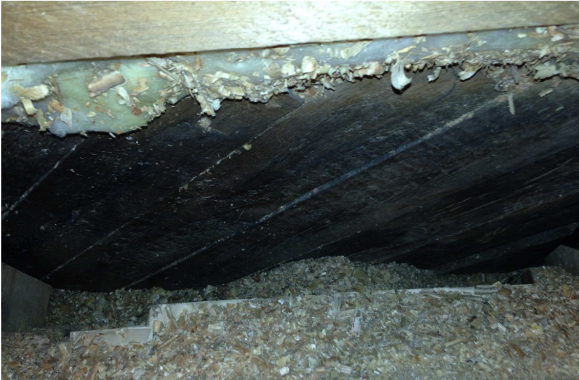
KUVA 8. Sisäpuolisesta kosteudesta kosteusvaurioitunutta vinolaudoitusta ja purueristettä seinän yläosassa
