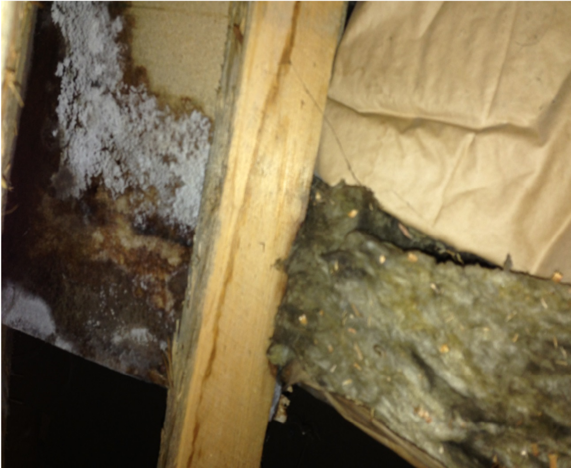
KUVA 15. Mikrobivaurioituneita eristeitä sivu-ullakoissa
