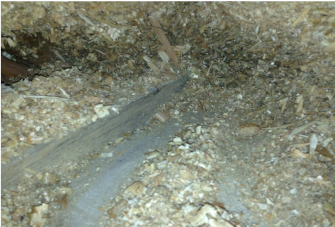
KUVA 7. Alapohjan purueristeen kosteusvaurio
