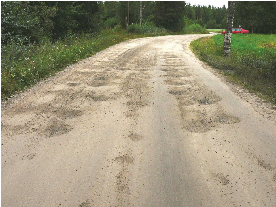
Kuva 7. Sorateiden kunnossapito-ohje 2014:sta on esimerkkikuvia teiden huonosta ja hyvästä kunnosta. Tässä kuntoluokan 1 eli huonoimman luokan kuntoa vastaava soratieosuus (Liikennevirasto 2014, liite 1/3(6)).
