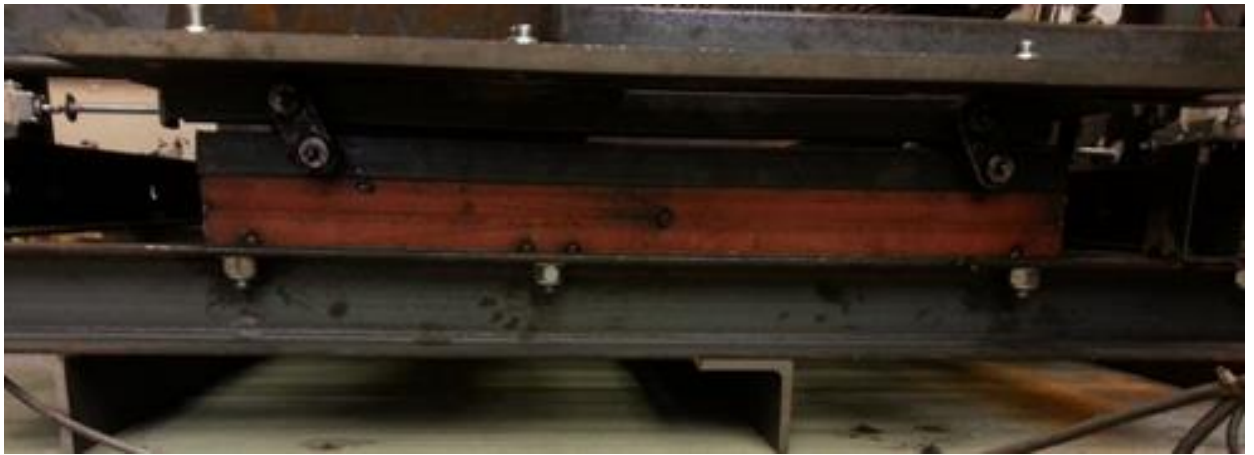
KUVA 13. Tavalliset työkalut eivät mahdu U-palkkien väliin pitämään pulttia kiristettäessä alapuolella näkyviä muttereita. (Kuva: Olli Isomäki 2014)
