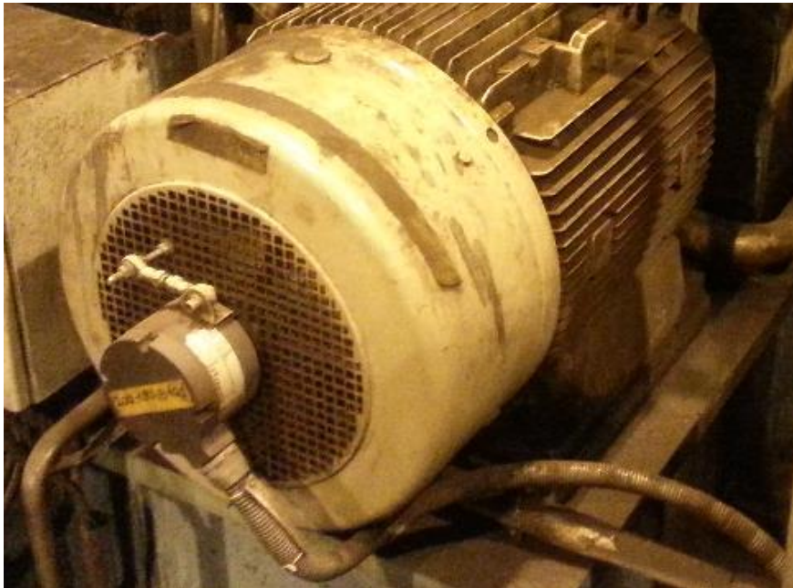
Kuvio 30. Moottorin akselille N-päähän asennettu enkooderi
