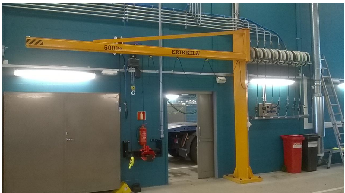
Kuva 18. Nostopuomi Jyväskylän aikuisopiston korjaamotiloissa.
