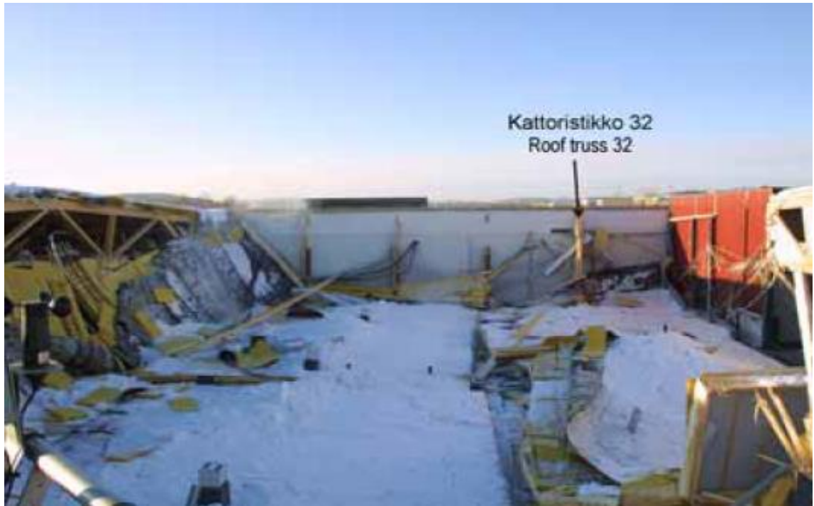
Kuva 7. Esimerkki ennakoimattomasta onnettomuudesta. Puuelementtien valmistusvirheestä ja kattorakenteiden puutteellisesta suunnittelusta aiheutunut kattorakenteen jatkuva sortuma. [4, s. 2.]
