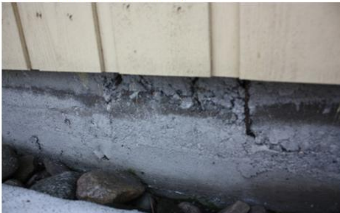
KUVA 5. Kattilahuoneen sokkelin rakenneteräkset näkyvillä (Siikanen 2015.)
