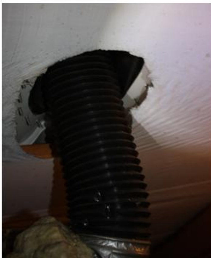
KUVA 19. Läpiviennin eristyksen puutteita (Siikanen 2015.)
