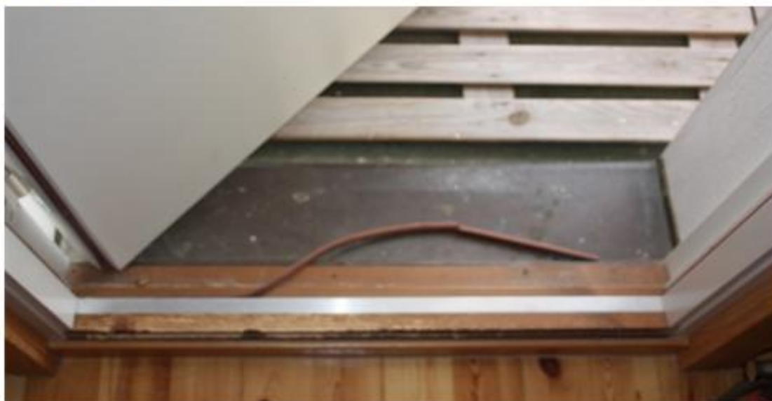
KUVA 15. Parvekeoven tiiviste on hapristunut ja osittain irronnut (Siikanen 2015.)
