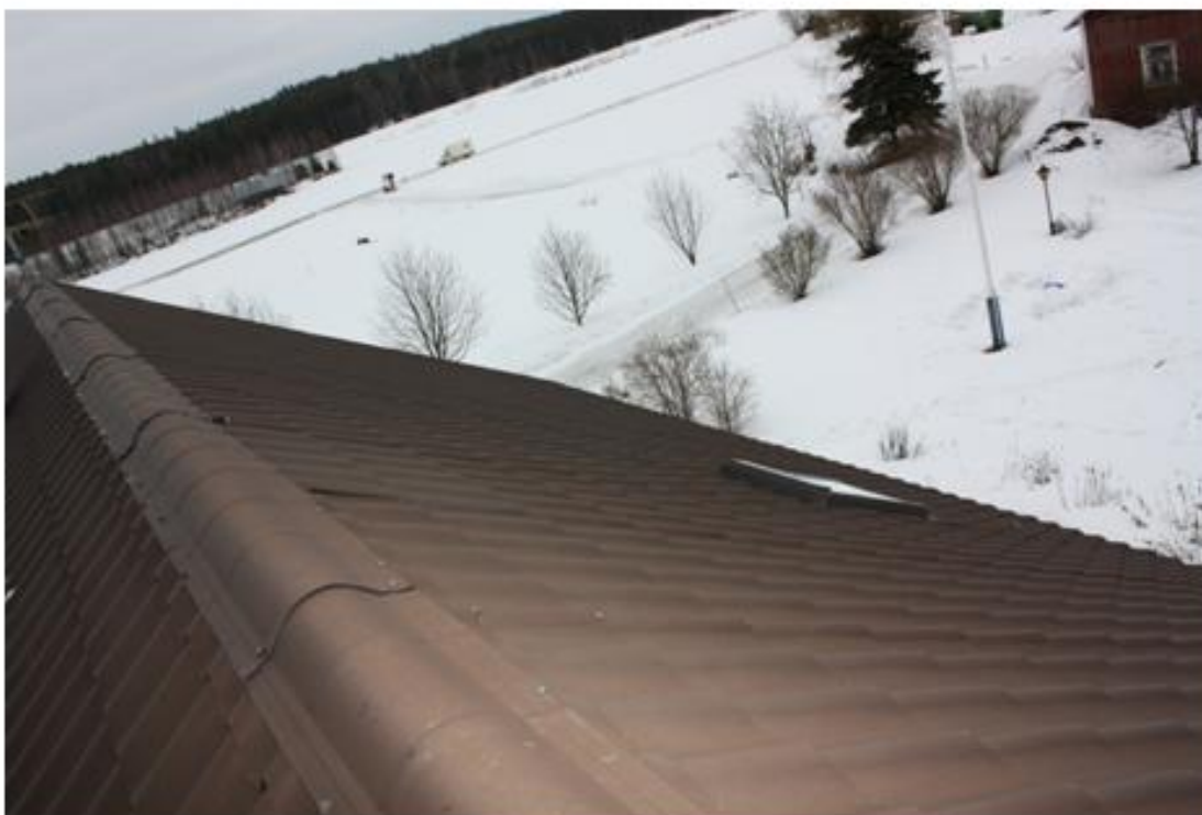
KUVA 21. Katteelta puuttuvat lumiesteet ovat turvallisuusriski (Siikanen 2015.)
