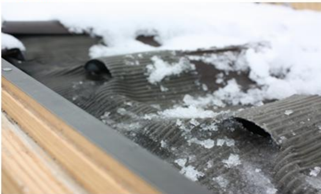
KUVA 20. Kattoikkunan läpiviennin pellit ovat vaurioituneet (Siikanen 2015.)
