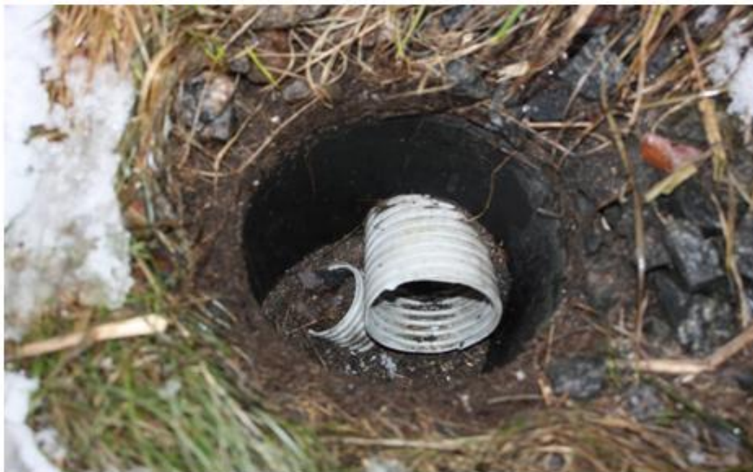
KUVA 2. Sadevesikaivoissa on hiekkaa ja muita roskia (Siikanen 2015.)
