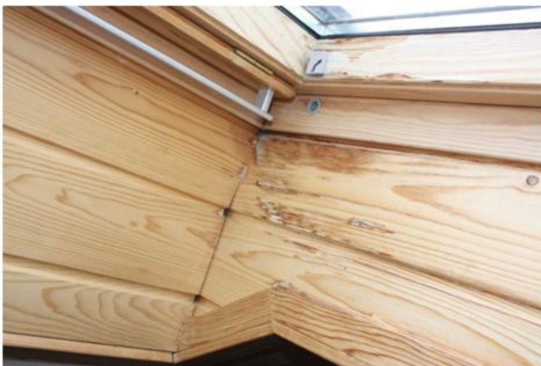
KUVA 14. Kattoikkunan vaurioita (Siikanen 2015.)
