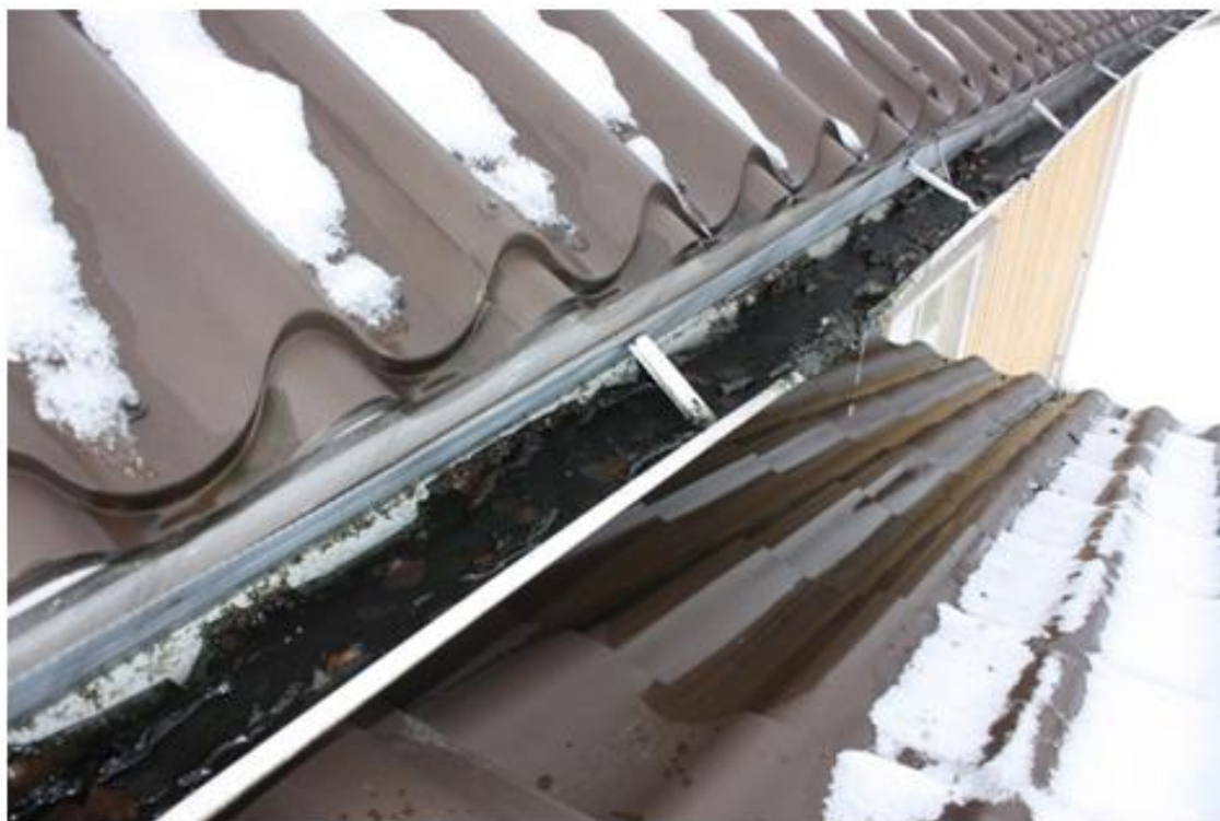
KUVA 3. Sadevesikouruja ei ollut puhdistettu lehdistä (Siikanen 2015.)
