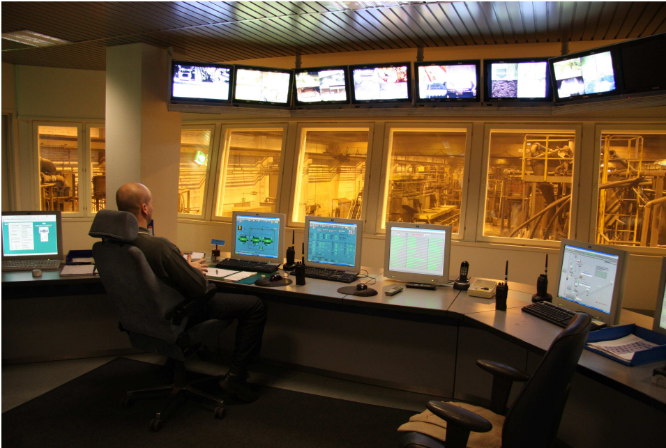
KUVA 21 Tyypillinen valvomotila kaivosteollisuudessa (19, s. 22)
