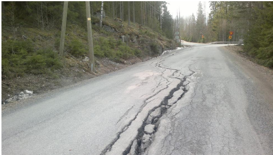
Kuva 1. Roudan aiheuttamia vaurioita tien alkuosalla.
