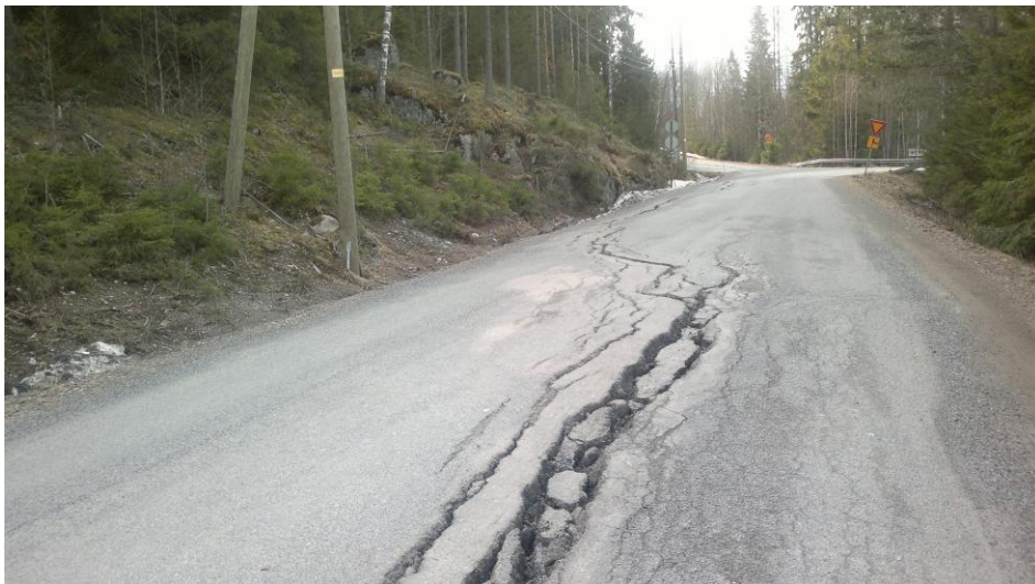
KUVA 2. Tien alkuosuudella oleva routavaurio (Anne Kasari 2014)
