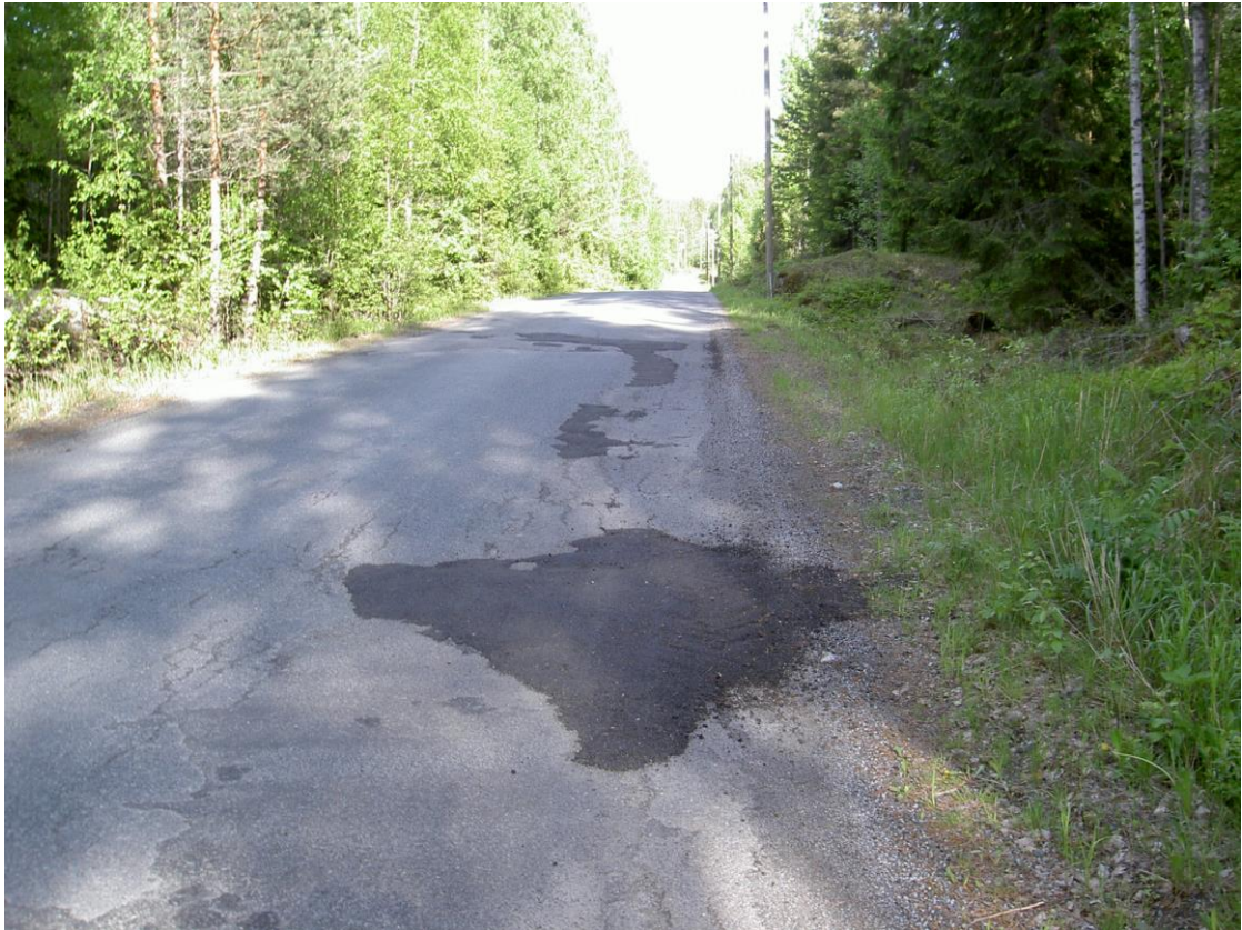
KUVA 3. Paaluvälillä 900 - 960 olevia routavaurioita (Olli Halme 2014)
