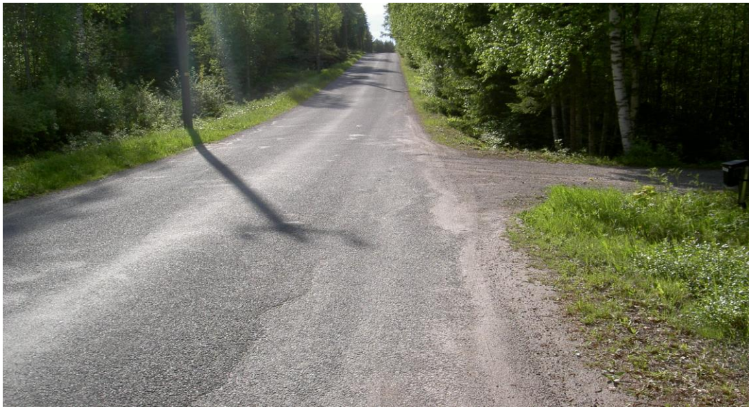
KUVA 4. Päällysteen vanhaniän tuomaa epätasaisuutta (Olli Halme 2014)
