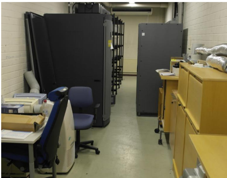
KUVA 6. UPS-laitetila, jossa ylimääräistä tavaraa
