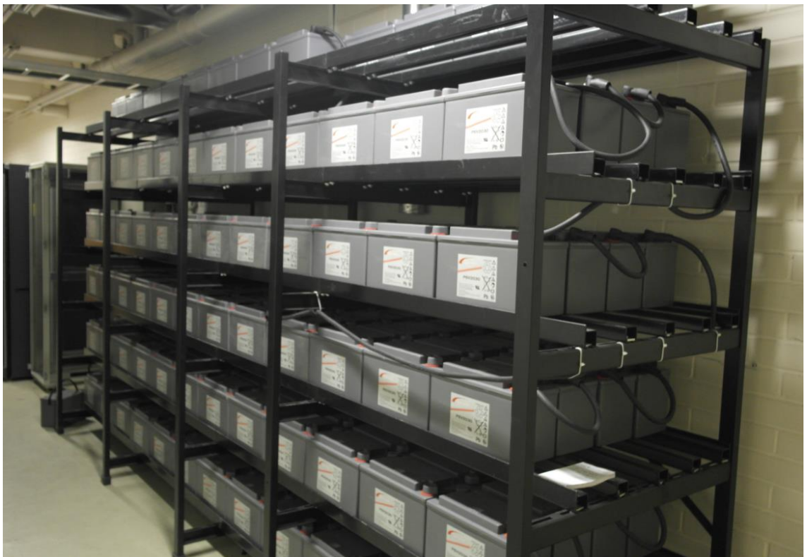
Kuva 6: UPS-laitteen akusto, jännitetaso 408 VDC, kapasiteetti 290 kWh
