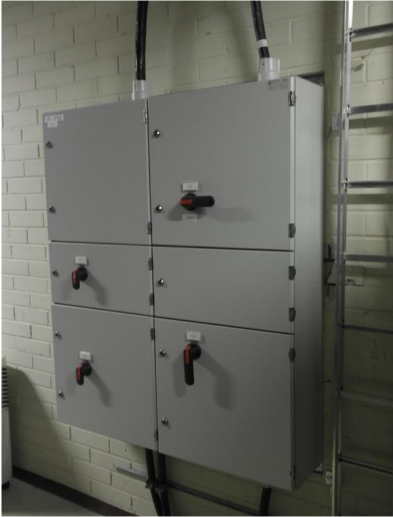
Kuva 3: UPS2-keskus, jossa syöttö- ja ohituskytkimet
