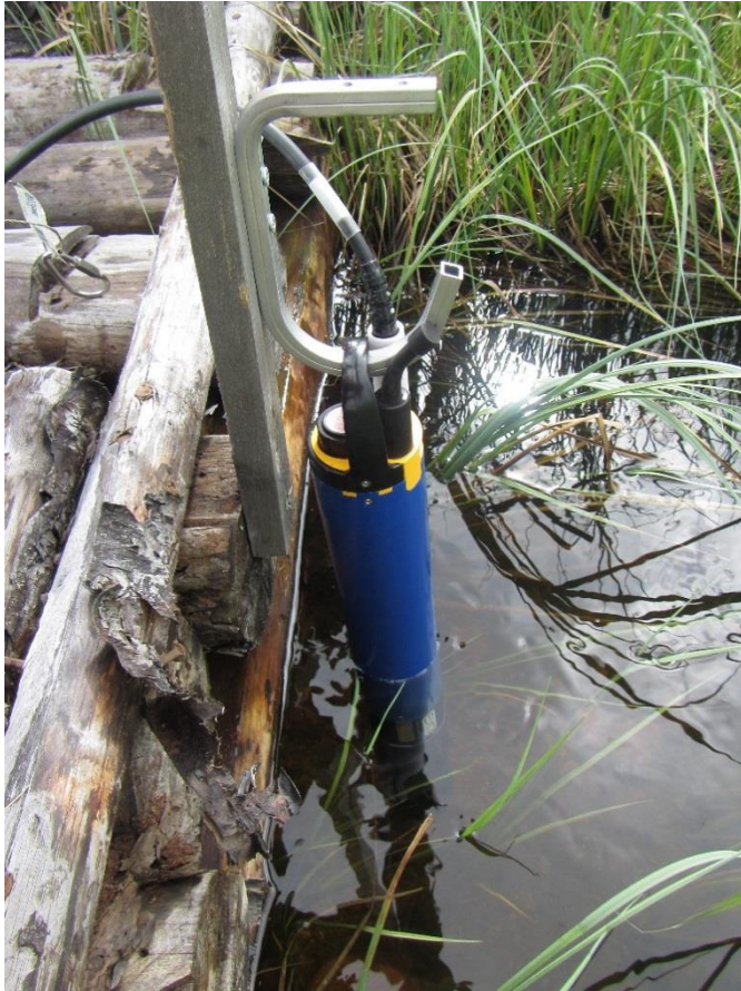
KUVA 5. YSI EXO2 -mittalaite asennettuna prosessivesien purkuojaan.
