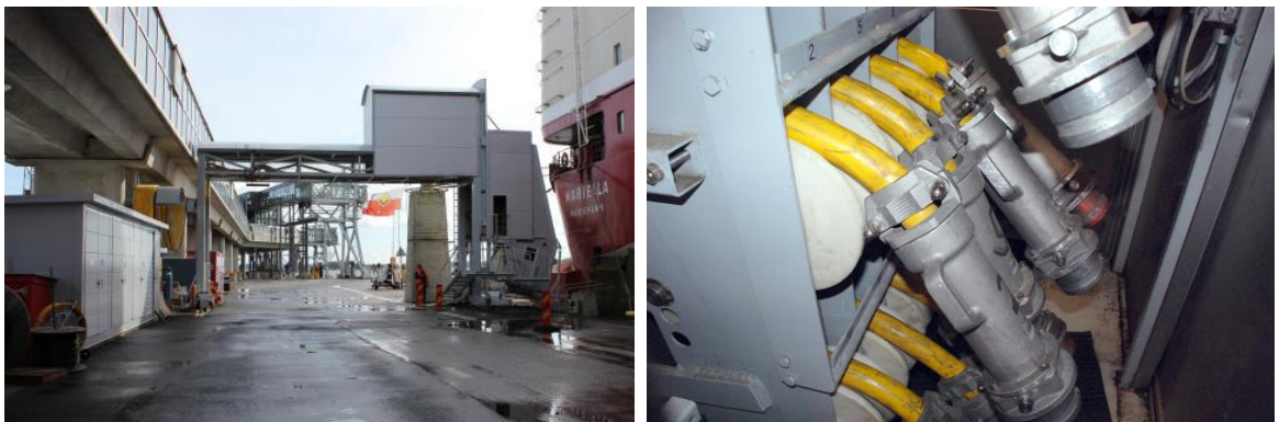
Kuva 2. Kaapelisilta (vasemmalla) ja yhdistyspisteessä sijaitsevat liittymiskaapelit (oikealla) (Kuva: Port of Helsinki)
