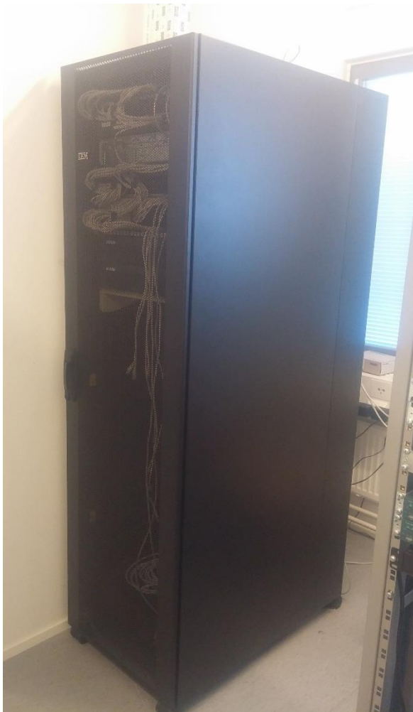
Kuvio 8. Luokan A350.3 takahuoneessa sijaitseva tietoliikennekaappi
