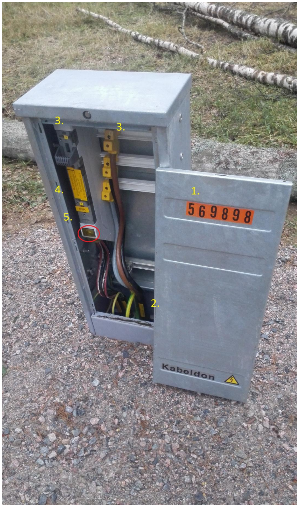
Kuva 7. Jakokeskuksen varokeyttimeen merkintätavat herättivät keskustelua kuukausipalaverissa (Lintukorpi 2015)
