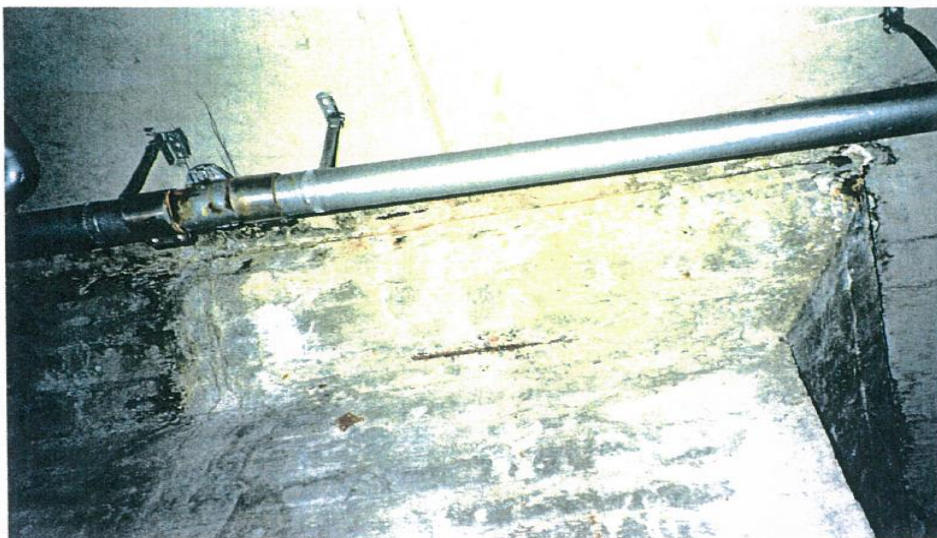
Kuva 9. Lasten altaan konsolissa on rakennevaurioita.
