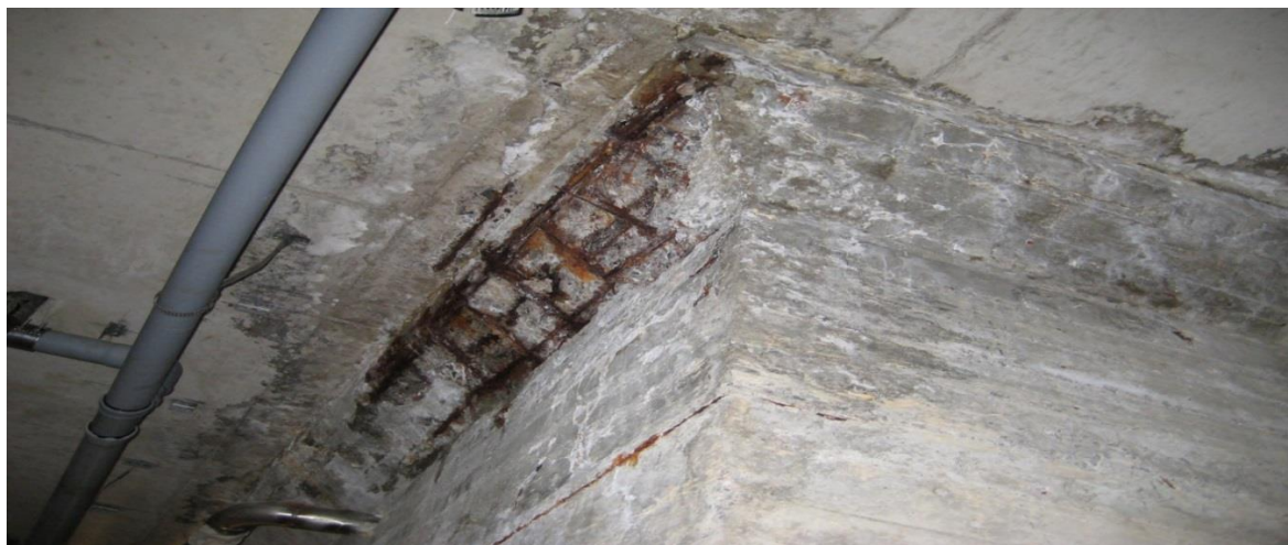
Kuva 2. Pahiten vaurioitunut lastenaltaan kulma, kuvattuna kesällä 2014 Heikki Sopanen
