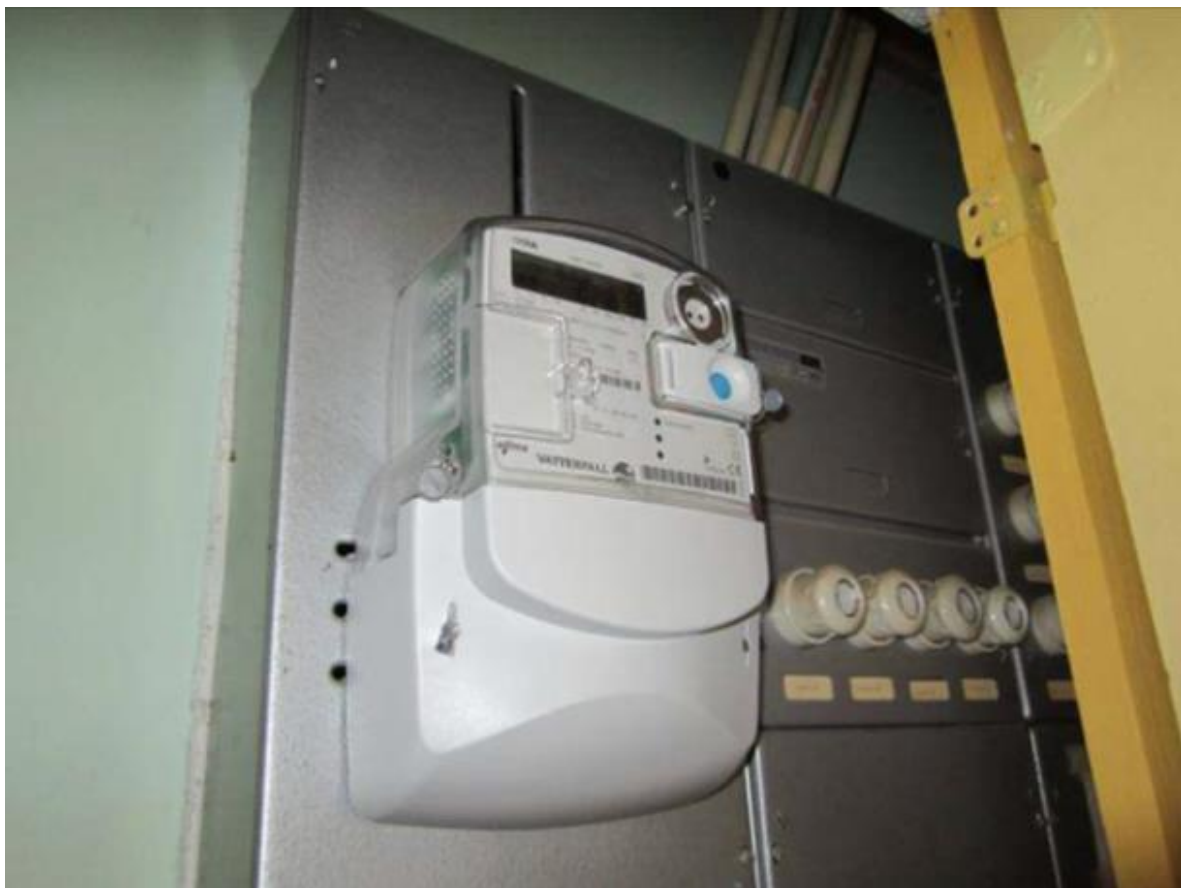
Kuva 23. Sähkökeskus ja -mittari (Miettinen 2014)
