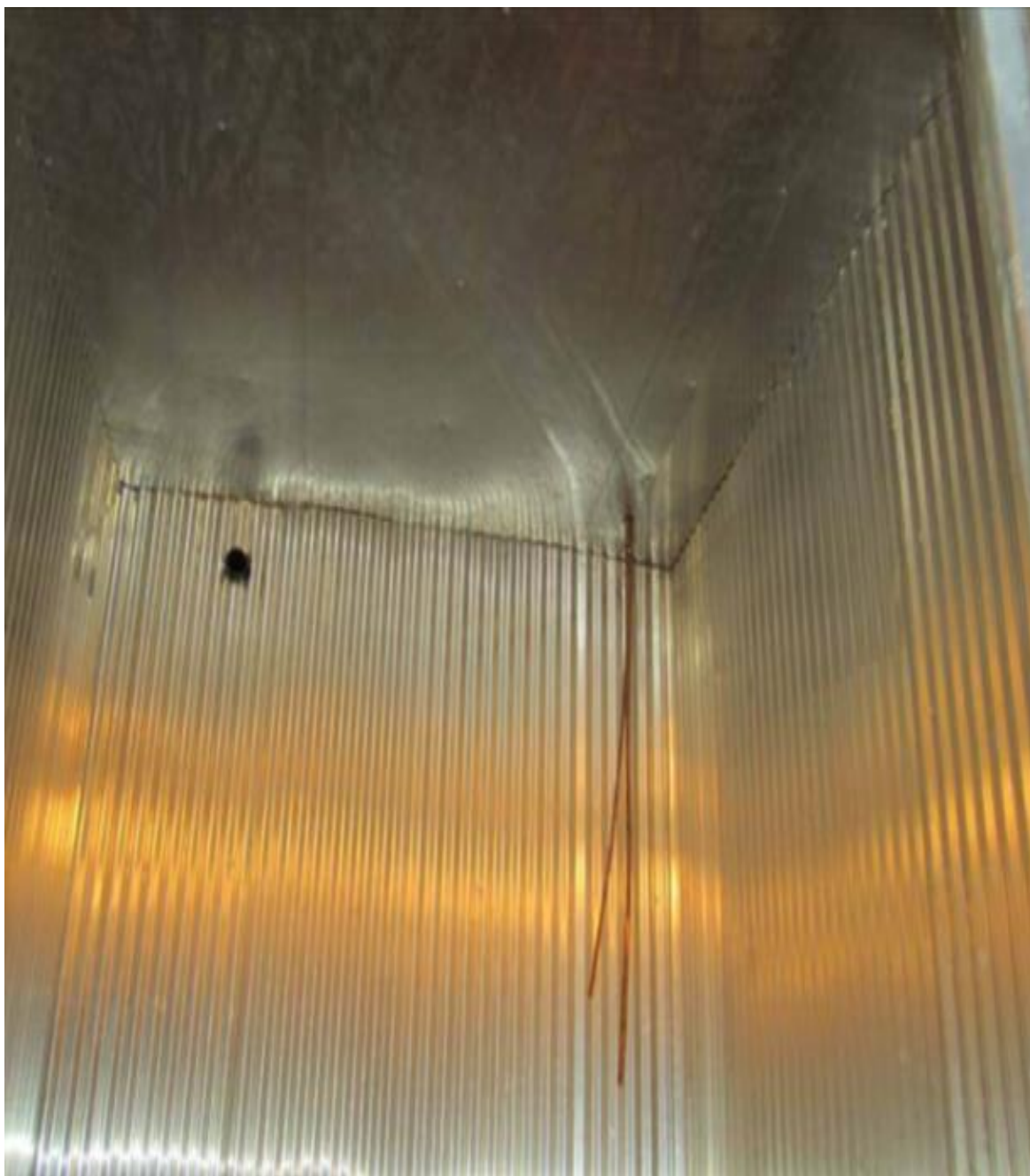
Kuva 14. Kylmiön kylmälaitteen putket (Miettinen 2014)
