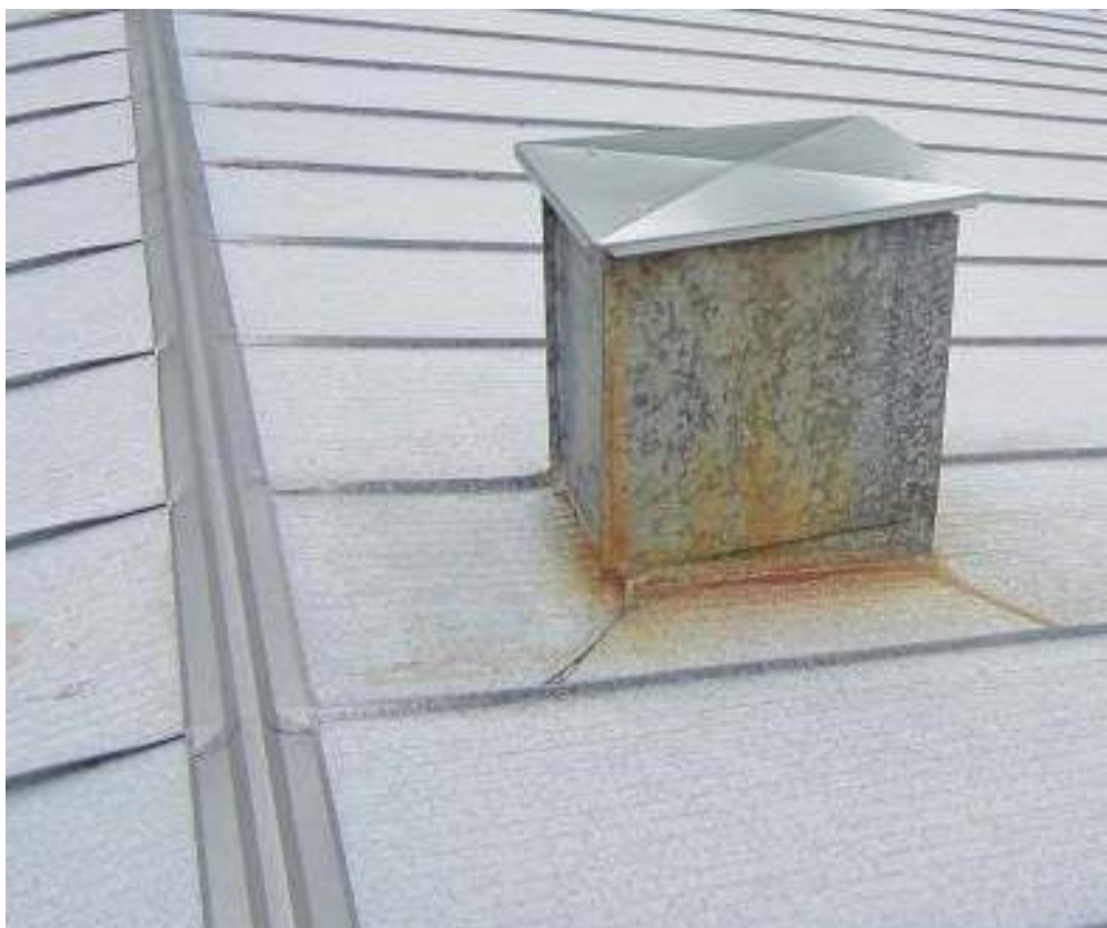
Kuva 43. WC:n katosta nouseva hormi (Miettinen 2014)
