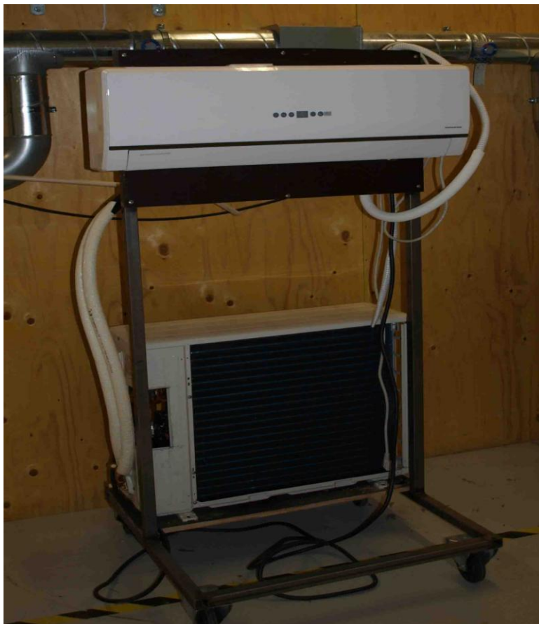
KUVIO 1. Ilmalämpöpumppu siirrettävällä telineellä
