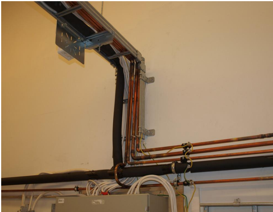
KUVIO 14. Pakastehuoneen putkilinjoja
