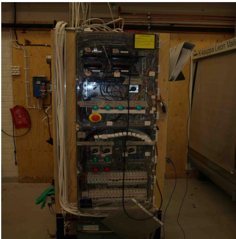
KUVIO 19. Kaupan kylmälaitteiston sähköpääkeskus
