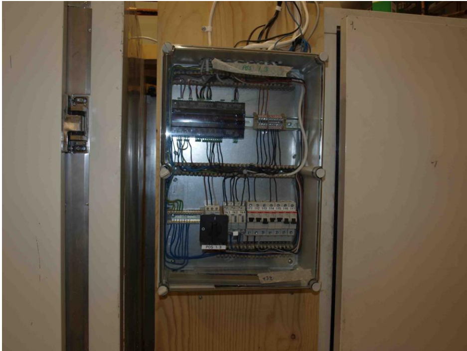
KUVIO 20. Kaupan kylmälaitteiston alakeskus kylmiön seinässä
