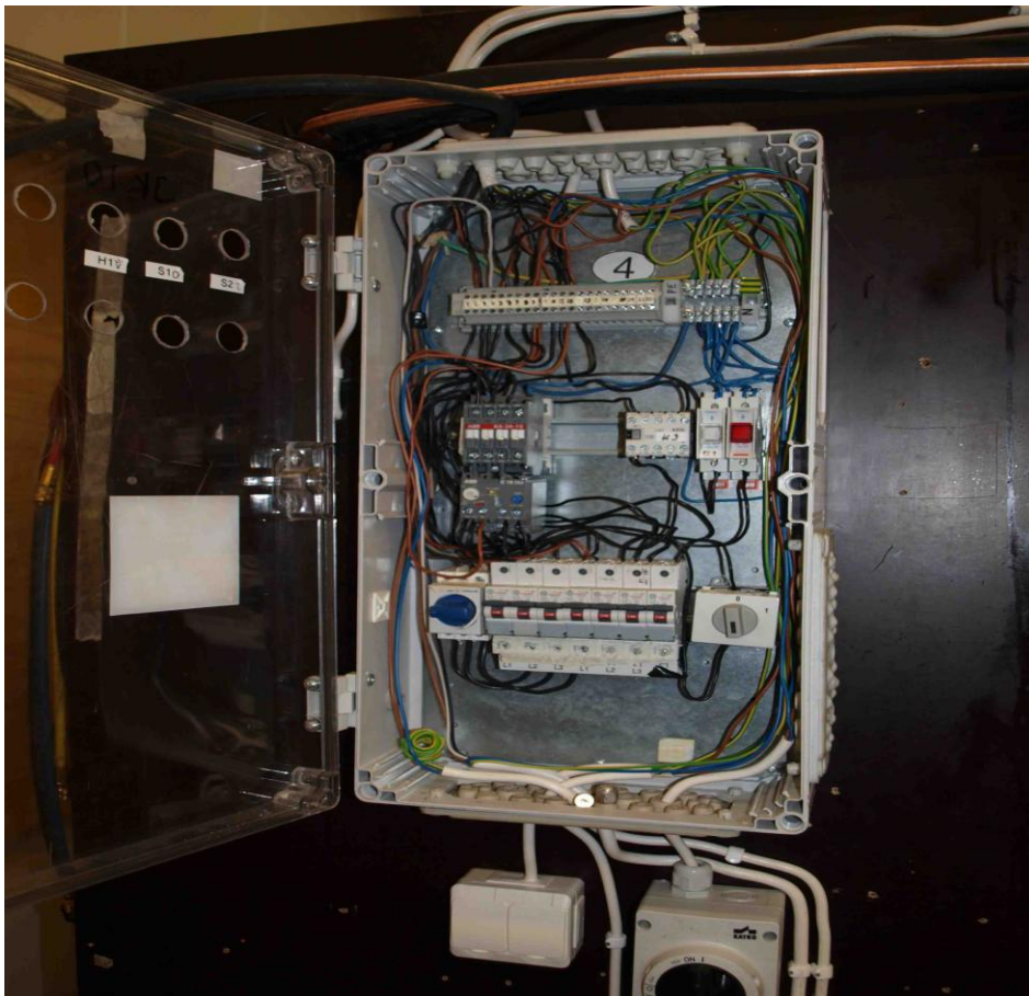
KUVIO 17. Pienen kylmlaitteiston sähkökeskus
