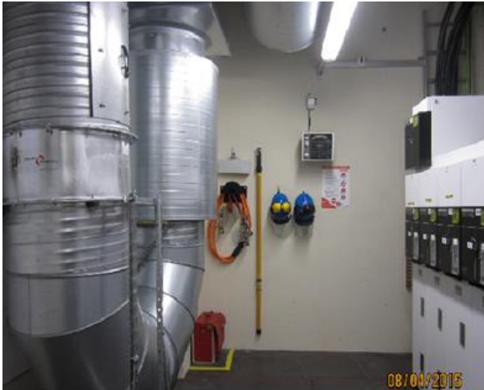
KUVIO 8 Muuntoasema 2 5S-tarkastelun jälkeen
