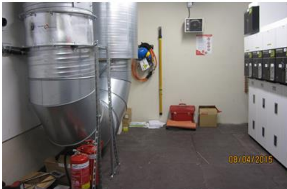
KUVIO 7 Muuntoasema 2 ennen 5S-tarkastelua
