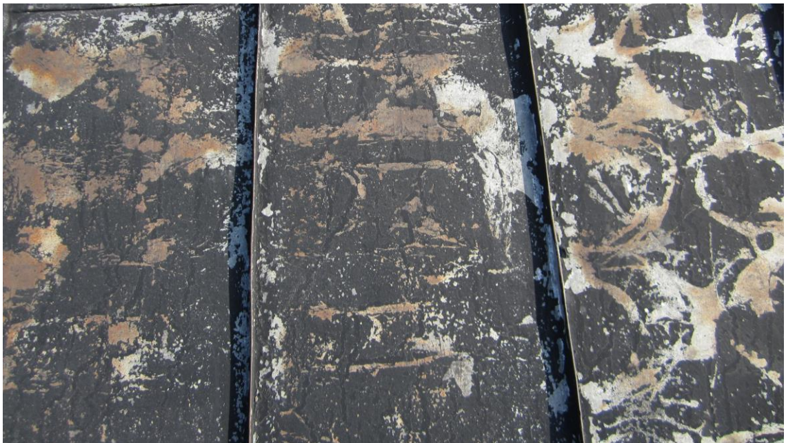
Kuva 4. Tutkittavana olevan peltikaton pinnoitteen kunto.
