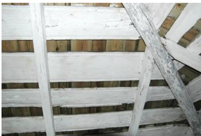
Kuva 11. Ruodelaudoituksen vanhan lautakatteen lautoja.
