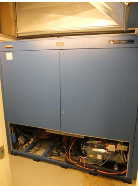
Kuva 15 Vakioilmastointikone I-056 silecs, puhdastilat
