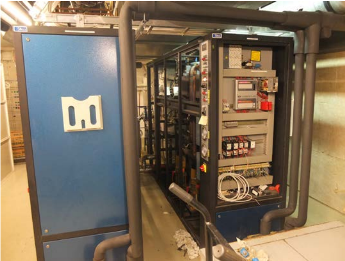
Kuva 6 Vedenjäähdytyskoneikot I-130 VJK A ja I-130 VJK B
