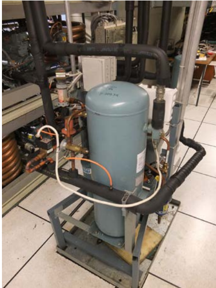
Kuva 2 Ilmanvaihdon jäähdytyskompressori II-009JK
