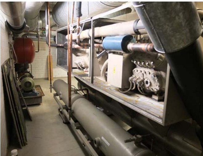
Kuva 10 Vedenjäähdytyskoneikko II-180 VJK
