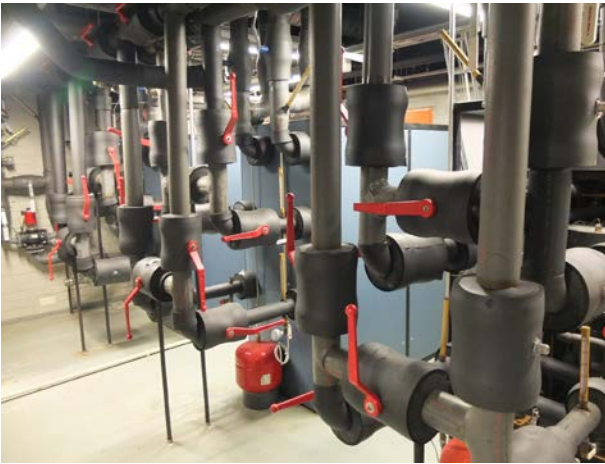
Kuva 7 Vedenjäähdytyskoneikot I-1006 CPU, I-1007 CPU ja I-1008 CPU
