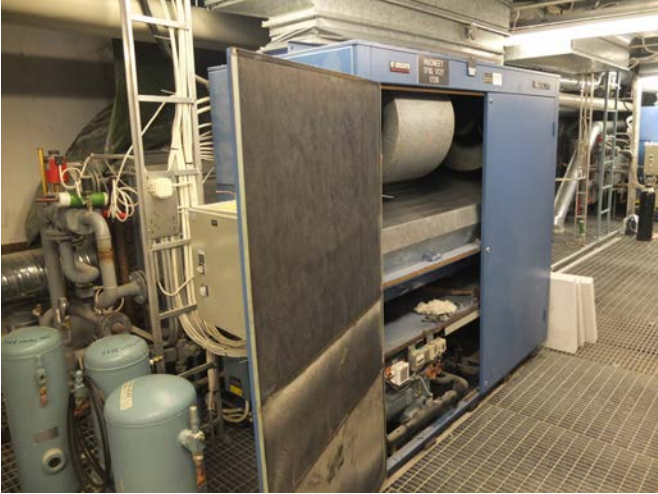
Kuva 19 Vakioilmastointikone II-057 Tapiolan lukio
