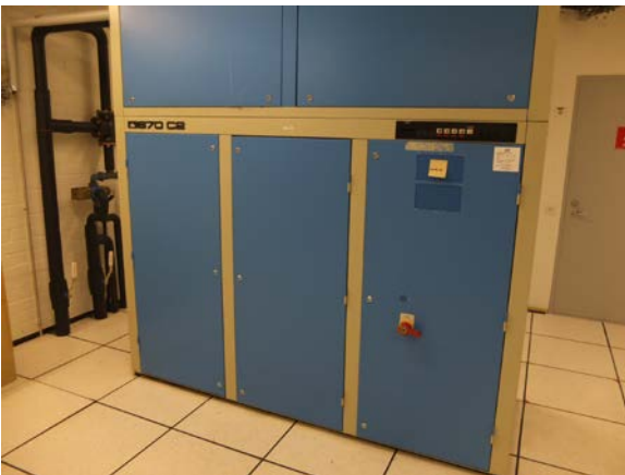
Kuva 16 Vakioilmastointikone I-1010 sähkötilat, UPS
