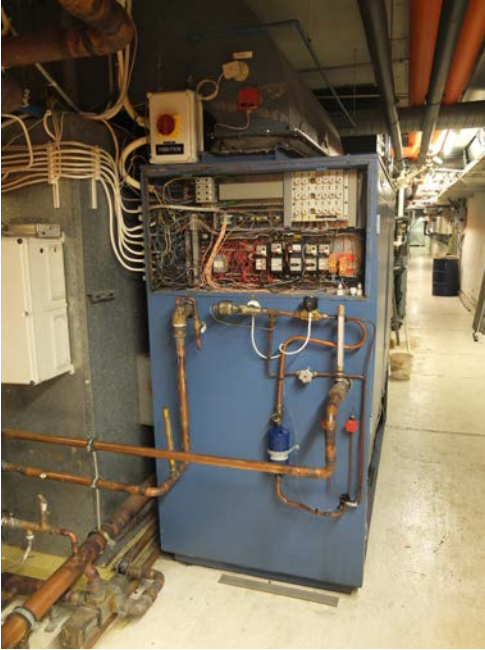
Kuva 14 Vakioilmastointikone I-080 silecs, puhdastilat
