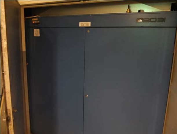
Kuva 18 Vakoilmastointikone I-780 Crescom konesali
