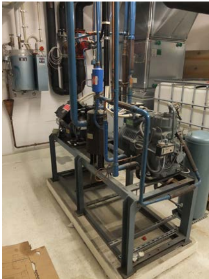
Kuva 1 Ilmanvaihdon jäähdytyskompressorit I-020JK ja I-120JK
