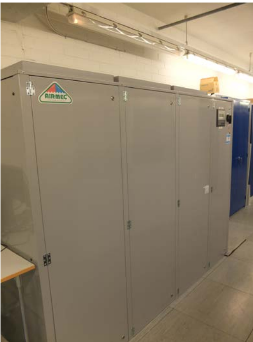
Kuva 17 Vakioilmastointikone I-1020KK2 Crescom konesali
