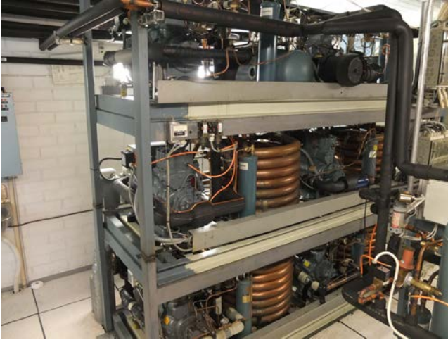
Kuva 3 IBM- konesali jäähdytys II-001 -004
