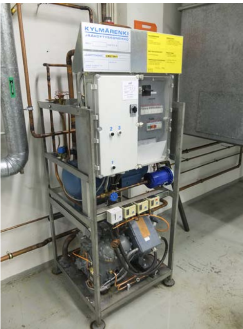
Kuva 4 Ilmanvaihdon jäähdytyskompressorit I-1013
