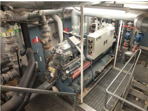
Kuva 8 Vedenjäähdytyskoneikko II-206 VJK
