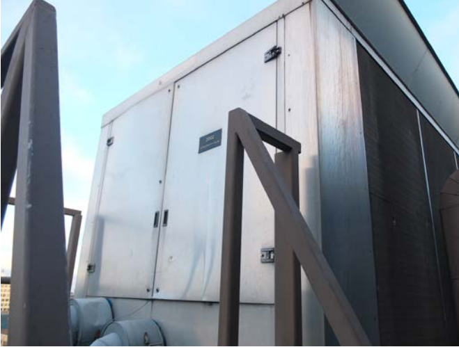
Kuva 11 Vedenjäähdytyskoneikko III-2002 VJK
