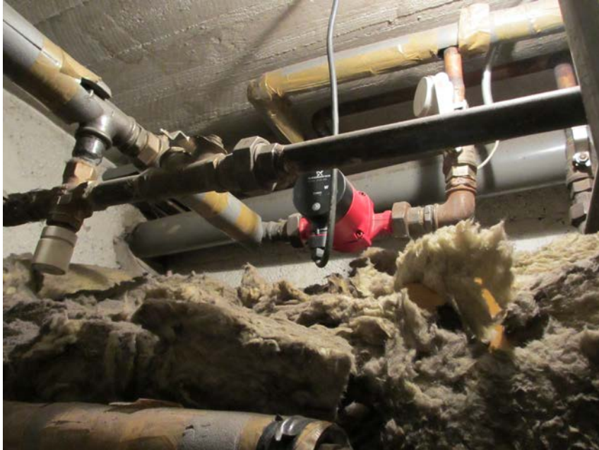
Kuvio 3. Lämmitysverkon kiertovesipumppu
