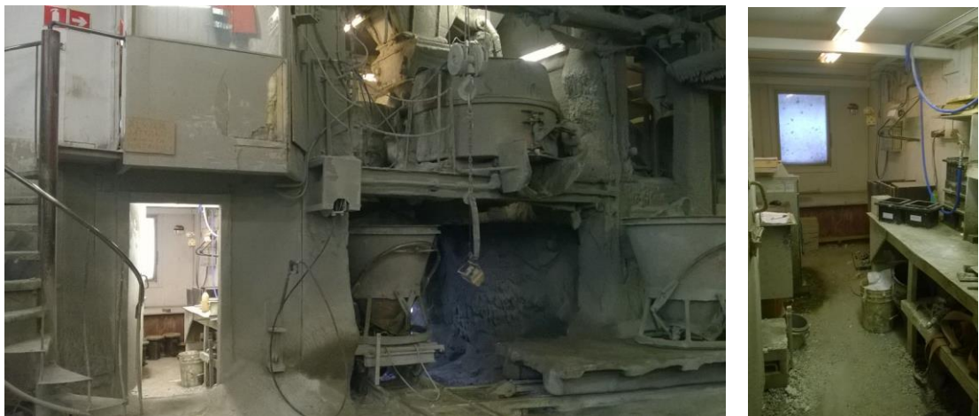
Kuvio 2. Betoniasema ja tarkempi näkymä laboratorion ovesta sisään
