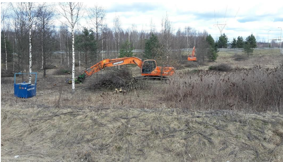
Kuva 9. Työmaalla kaksi giljotiinikouralla varustettua kaivinkonetta. Mikään ei kerro työmaan vaarallisuudesta eikä turvaetäisyyksistä.
