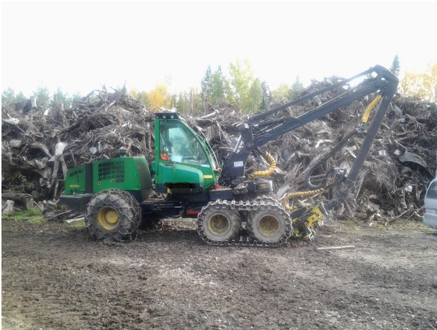
Kuva 8. Kone eräältä taajamatyömaalta; mistään ei ilmene vaara-alue.
