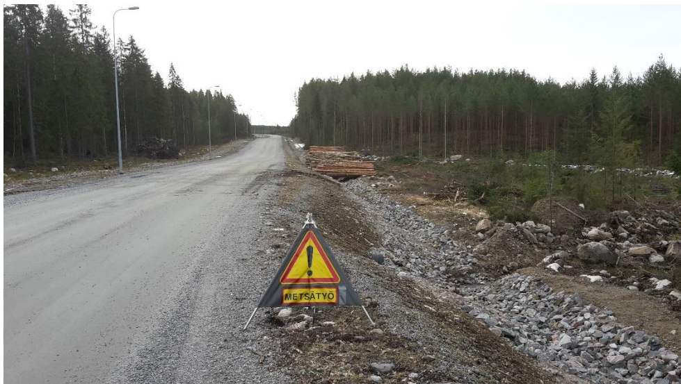
Kuva 5. Kolmiojalka varoitusmerkki. Hyvin näkyvä, mutta matalalla sijaitseva kyltti. Huonoa tässä mallissa on sen herkkyys tuulelle ja varkaille.
