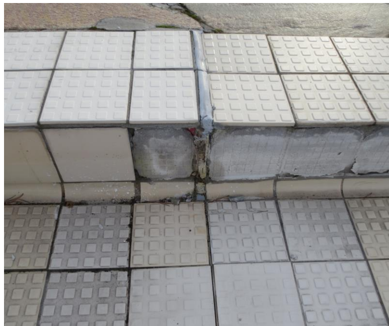
Kuva 9. Laatoituksen liikuntasauga jalkojenhuuhtelualtaan pohjalla on huomattavasti rakenteellista liikuntasaumaan kapeampi. Allastasanteen ja sen otsan alueella liikuntasaumaa on levennetty paikkakorjausten yhteydessä.
