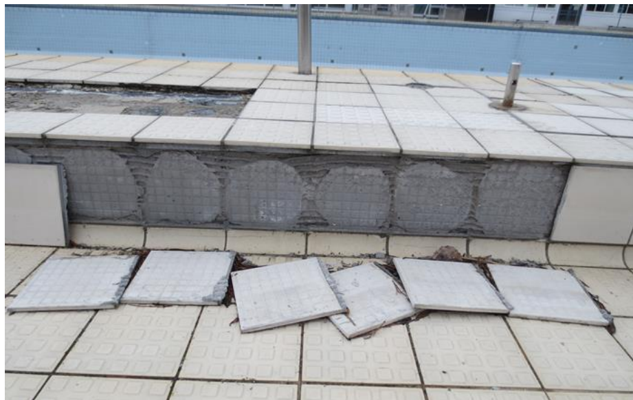
Kuva 11. Irronneita laattoja allasanteen otsa-alueella. Laattojen ja alustan välinen tartunta ei ole riittävä.
