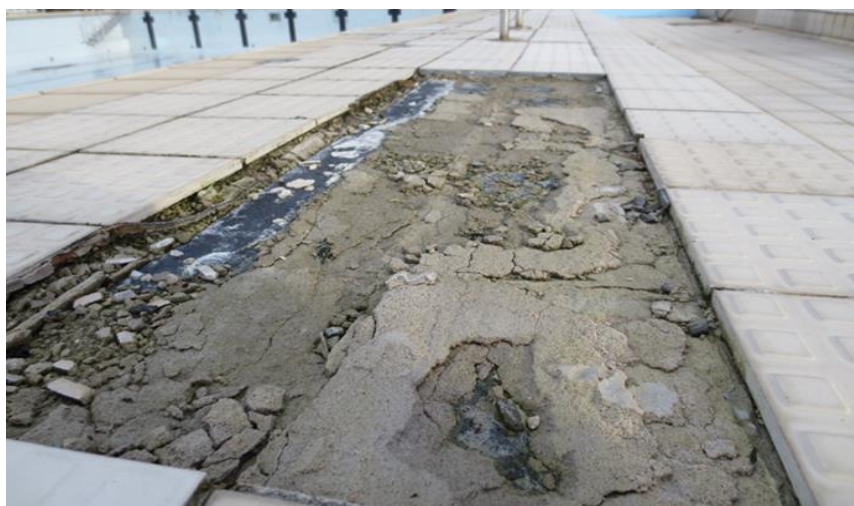
Kuva 6. Laatoitusvaurio allastasanteella. Kiinnityslaastikerroksen rapautuminen on johtanut laattojen irtoamiseen.
