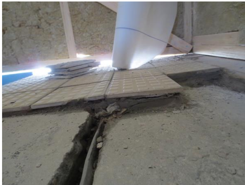
Kuva 20. Allasta kiertävä rakenteellinen liikuntasärmä oli ylitetty tasoitteella ja laatoilla.
