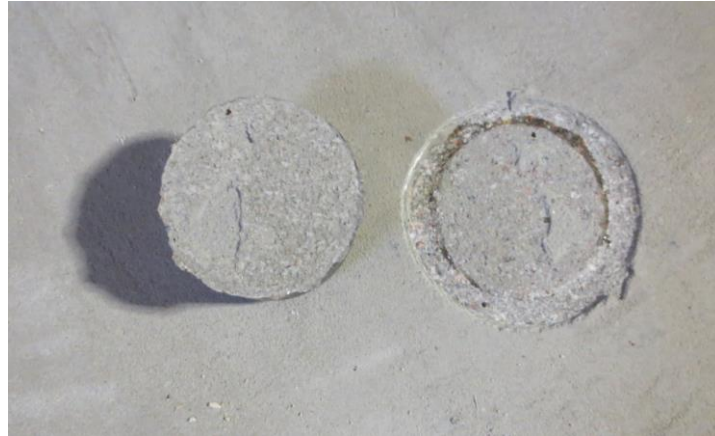
Kuva 42. Tasoitteelle suoritettu vetokoe. Murto on tapahtunut osittain alustabetonin ja tasoitteen rajapinnassa ja osittain tasoitteen sisäisenä murtona.
