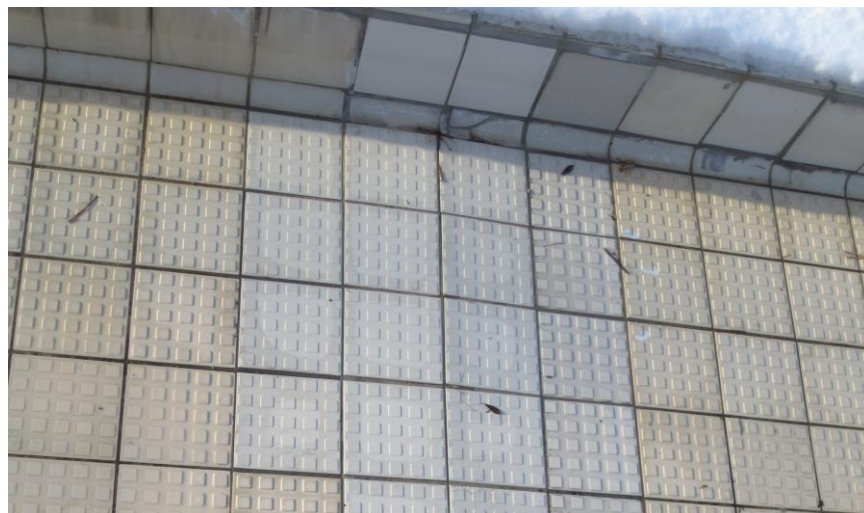
Kuva 5. Allastasanteet ja jalkojenhuuhtelukourut on pääosin laatoitettu neliönastapintaisella ja väriltään luonnonvalkoisella lasittamattomalla Pukkila Natura laatalla. Alkuperäisten ja paikkakorjauksissa uusittujen laattojen väriero on huomattava.
