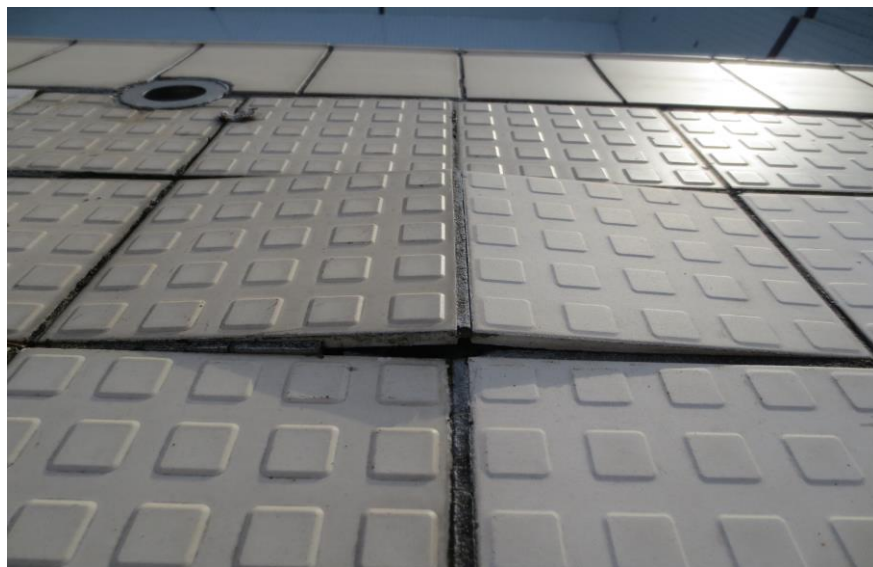
Kuva 8. Holvaantuneita laattoja allastasanteella.
