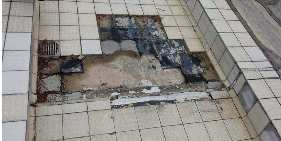
Kuva 10. Laatoitusvaurio jalkojenhuuhtelualtaan poikittaisen liikuntasauaman läheisyydessä. Vedeneristekerroksen kiinnitys alustaan on pettänyt ja sitä on jouduttu poistamaan paikkakorjausten yhteydessä.
