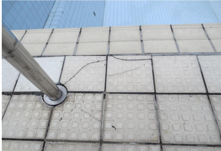
Kuva 7. Haljenneita laattoja allastasanteella kaidetolpan vieressä. Laattojen halkeilu on usein seurausta lämpöliikkeiden aiheuttamista jännityksistä.
