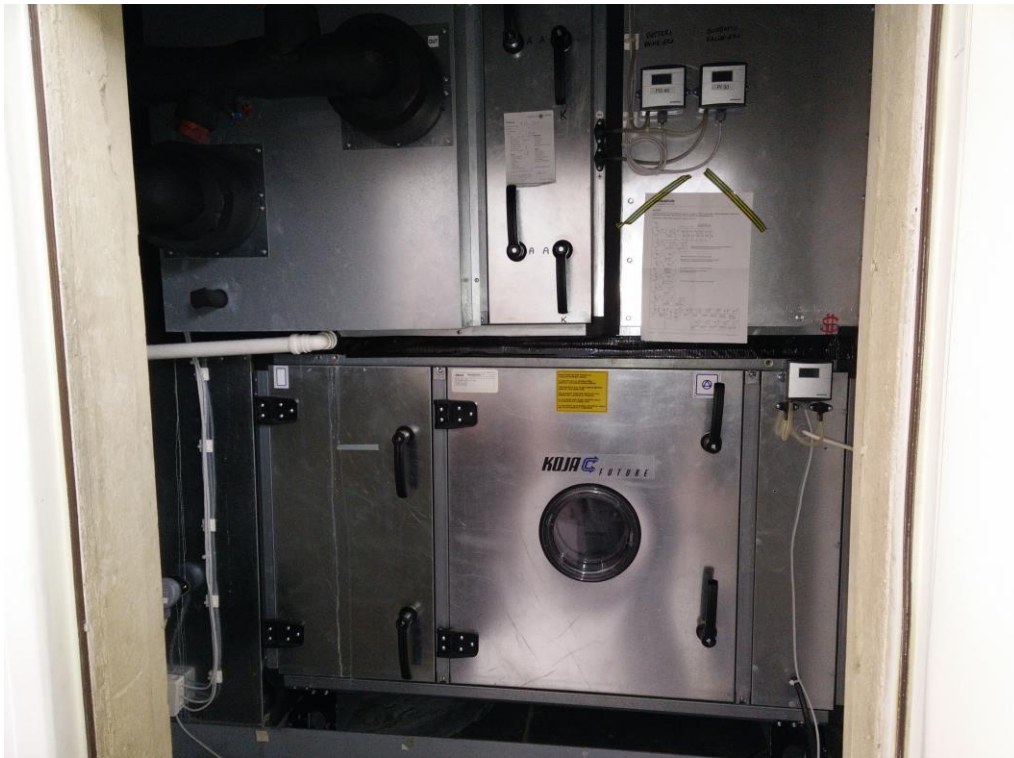
Kuva 11. Poistoilmapuhallin ja lämmön talteenottokenno
