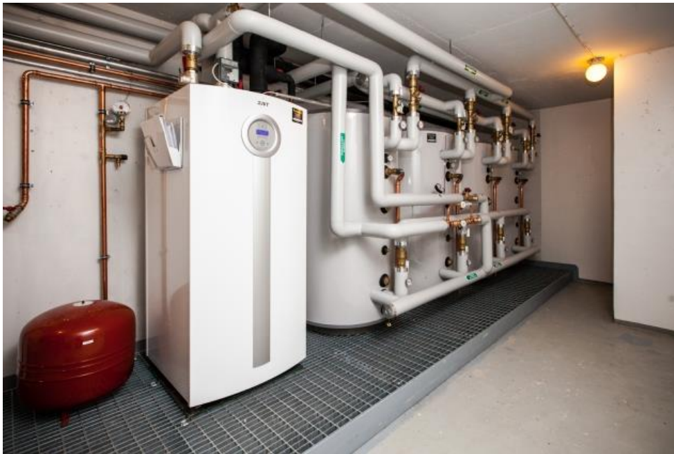
Kuva 10. Lämpöpumppu ja varaajat
