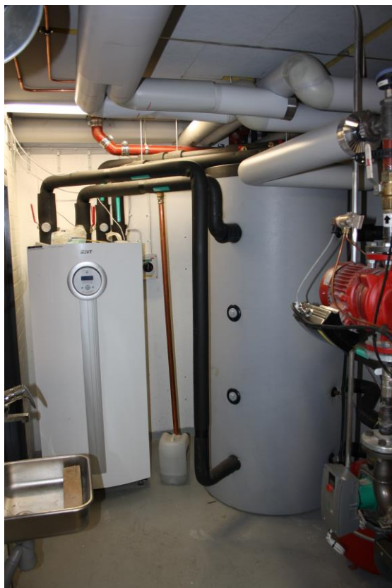
Kuva 15. Lämpöpumppu ja varaaja lämmönjakuhuoneessa
